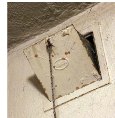
Käsisäätöinen ilmanvaihtoventtiili kellarissa.
