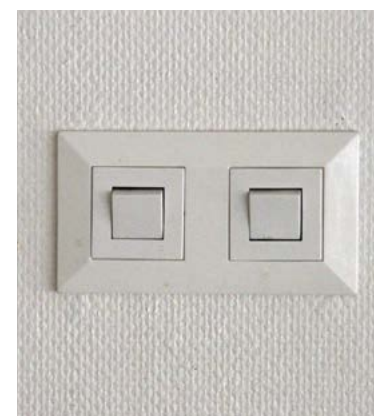
1980-luvulla uusittu kaksiosainen valaisinkatkaisija.
