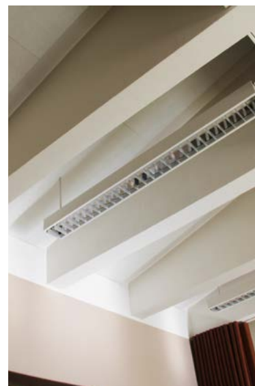
Kerhotiloissa alakatopalkkien väleihin on lisätty loisteputkivalaisimia.
