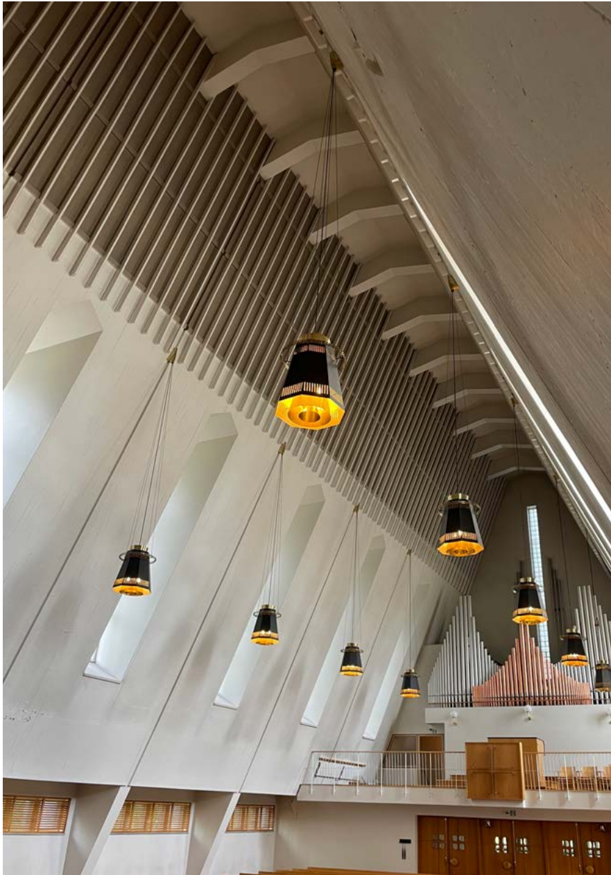
Kirkkosalin katto muodostuu sivuseinien liittymäkohtaan.
