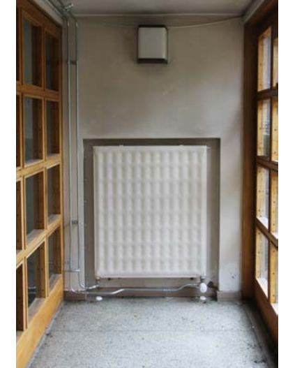
Tuulikaapissa on alkuperäinen patteri, jonka putkitus on uusittu.
