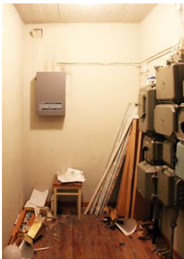
Sähköpääkeskus sijaitsee kellarikäytävän varrella.
