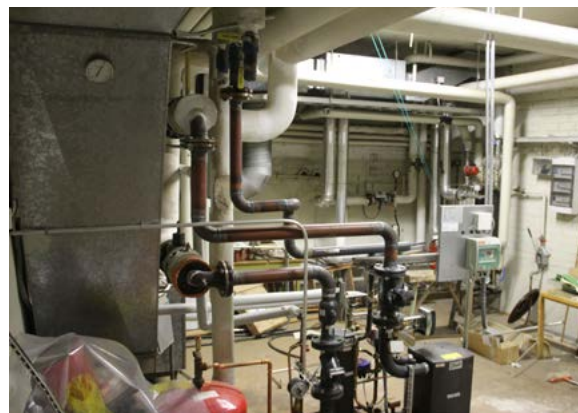
Lämpökeskuksen kattilalaitos on vaihdettu lämmönvaihtimeen. Tilaan on sijoitettu myös ilmanvaihtokone.
