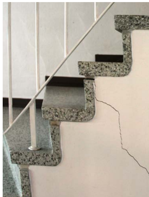
Mosaikkibetoniaskelmat on tuettu muuratun seinän päälle.
