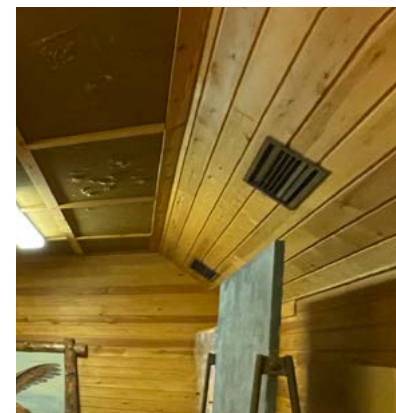
Laajennusosan kerhotilassa ilmanvaihtokanava on sijoitettu kattolaipioon.
