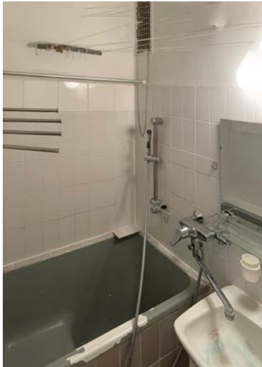
Asunnossa on vanha istuma-amme. Ammeen päällä on poistoventtiili.
