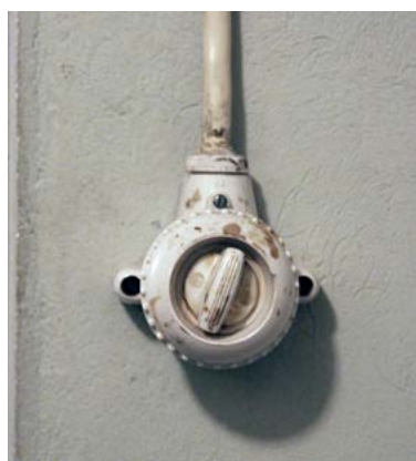
1950-luvun kierrettävä valaisinkatkaisija kehotilassa kellarissa.
