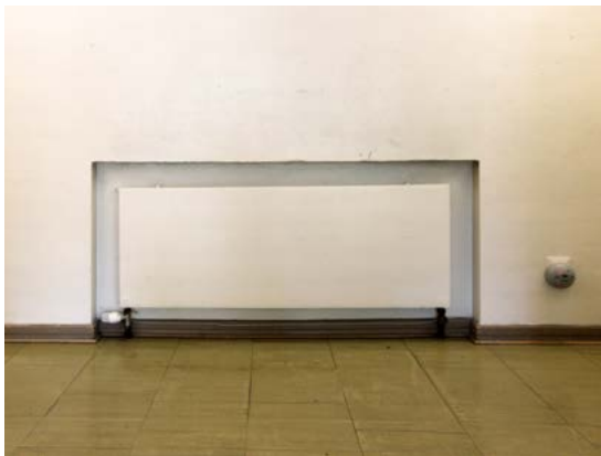
Kellarikerroksen käytävän lämpöpatteri on sijoitettu aikakauden tavan mukaan seinäsyvennykseen.
