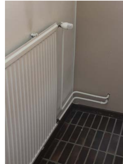
Kirkkosalin lämpöpatteri on uusittu.
