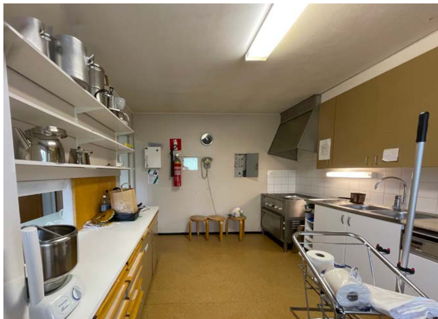
Näkymä keittiöön ikkunan suunnasta. Oikealla näkyvät alakaapit ja laitteistot on uusittu. Keittiöllä on oma sähkökeskus ja sen varustukseen kuuluu puhelin.
