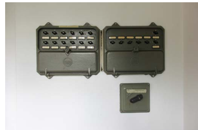
Käytävän seinässä on kirkkosalin valo-ohjauslaitteet. Ne ovat alkuperäiset ja vankkaa tekoa.
