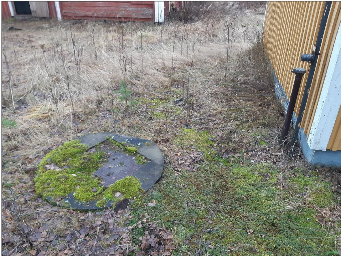
Kuva 4. Omakotitalorakennuksen maanalaisen lämmitysöljysäiliön sekä ilma- ja täyttöputkien sijainti (2.11.2021).
