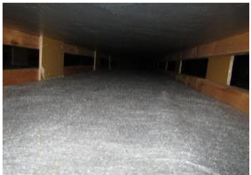
Kuva 66. YP3, Kuvaa kohdalla olevan alakaton sisään. Alakatto on kannatettu 50x50 rungoilla jotka roikotettu vanerilapuilla. Kiinnitysnaulausten määrä on vaihteleva.
