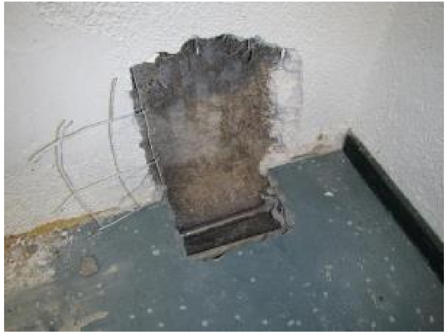
Kuva 40. US14. Sokkelin sisäpinnassa toja-levy, joka jatkuu lattiapinnan alapuolelle ja on kiinni täyttöhiekkakerroksessa. Kohdalla tunkkainen haju. Toja-eristeestä näyte M3, viittaa vaurioon.
