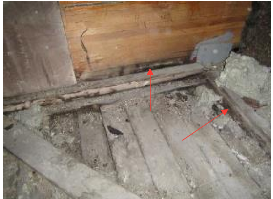
Kuva 56. Merkittävää lahoa yläpohjan kantavissa rakenteissa sekä pääkannatinpalkin alareunassa.
