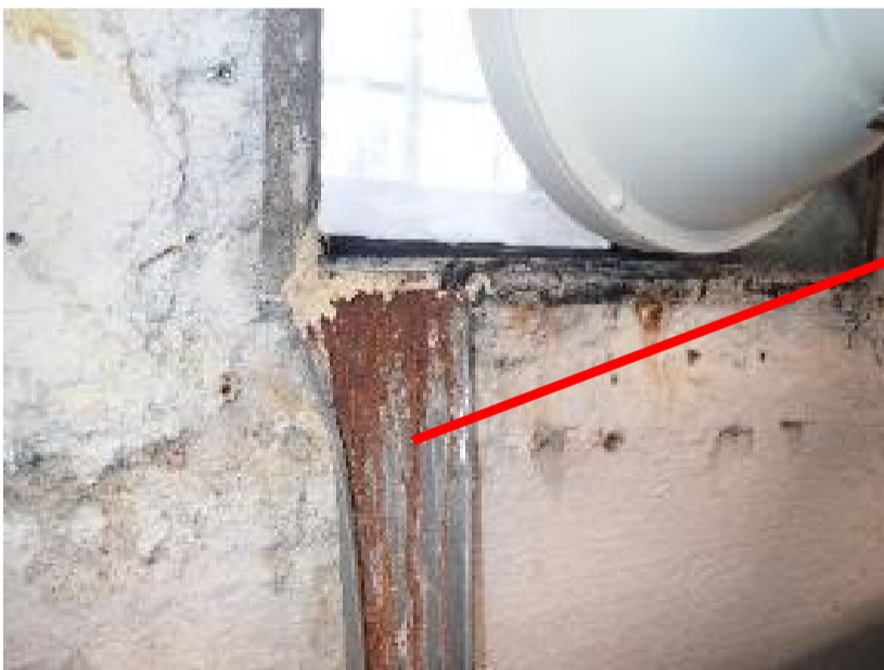
Kuva 114. Yhden kuntoaltaan ikkunan kohdalle oli tehty vuotovesille veden ohjauskouru.
