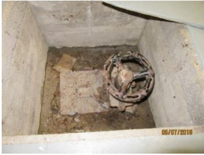
Kuva 202. Väestönsuojan valurautainen padotusventtiili
