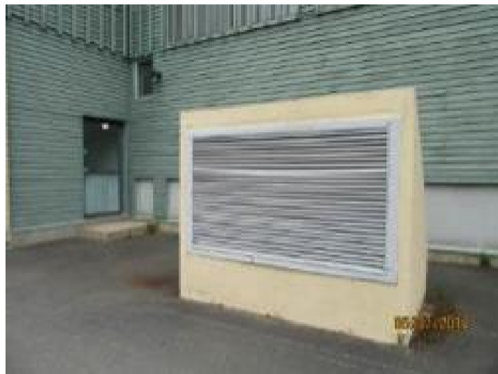
Kuva 228. Laitetilan ilmanvaihtokoneen ulkoilmasäleikkö
