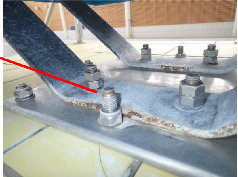
Kuva 131. Korokkeen metalliosissa alkavaa korroosiota
