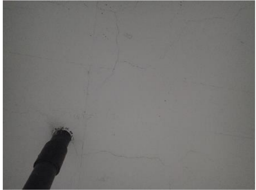
Kuva 139. Virkistysaltaan alapinnalla runkobetonin halkeilua
