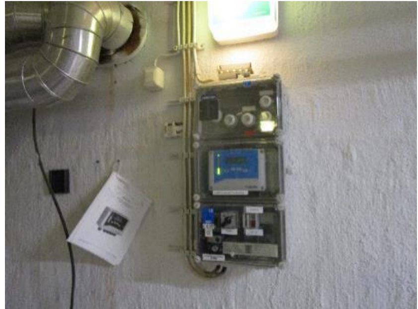
Kuva 163. Näkymä pumppukeskuksesta, kellari.
