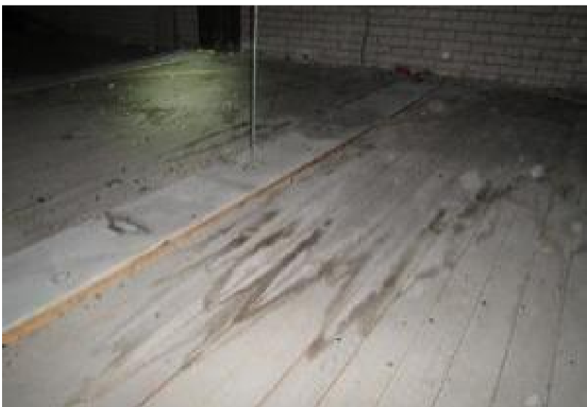
Kuva 53. Laajoja kosteusjälkiä ulkoseinän vierustoilla.
