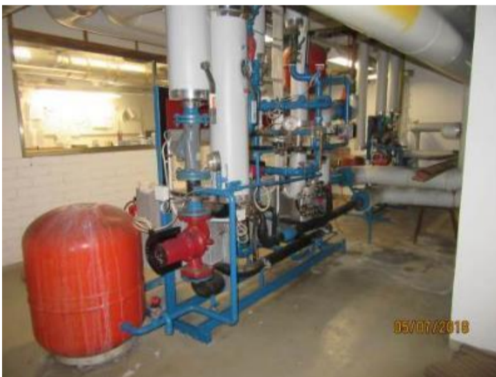
Kuva 179. Lämmityksen-, lämpimän käyttöveden- ja ilmanvaihdon lämmityksen lämmönjakokeskus
