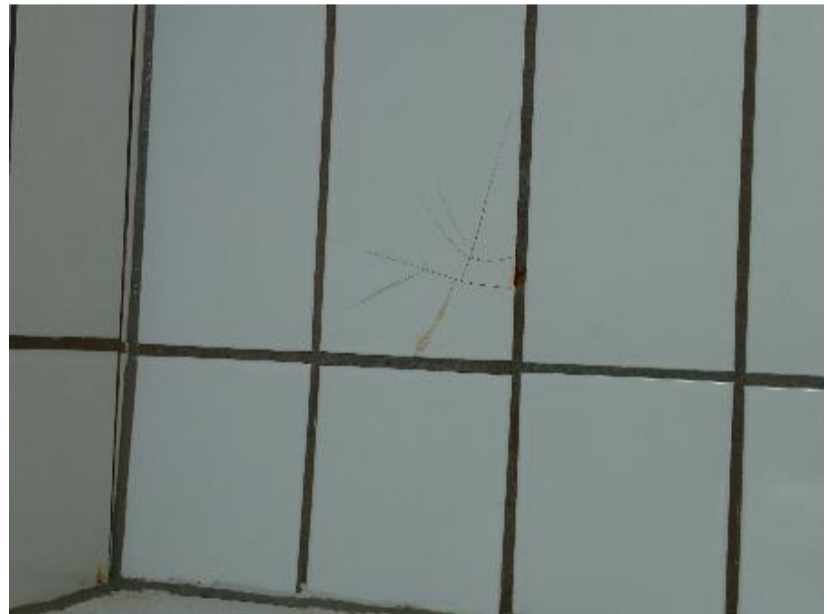
Kuva 125. Paikoin laattoja on halkeillut
