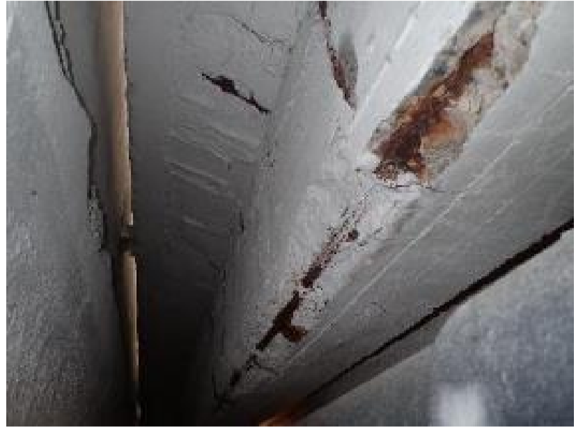
Kuva 117. Kuntoaltaan vierustan kävelytason alapuolen palkki on pahoin vaurioitunut vuotovesien aiheuttamasta teräskorroosiosta ja sen aiheuttamasta betonin lohkeilusta
