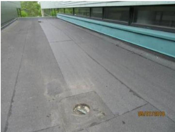
Kuva 211. Kattokaivosta puuttuu roskasihti
