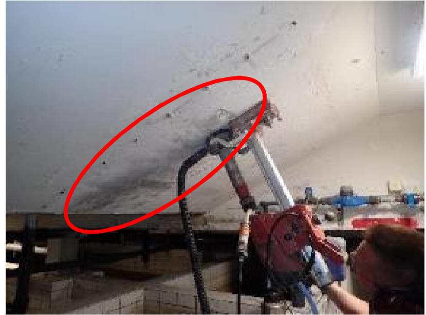
Kuva 121. Vuotovesien aiheuttamaa maalipinnan hilseilyä opetusaltaan alapinnalla
