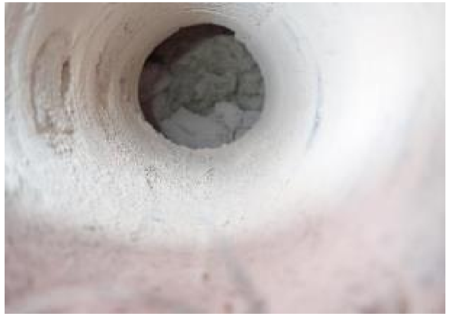
Kuva 24. US8. Kohdalla ei tuuletusväliä tiilimuurauksen ja eristevillan välissä. Näyte M7 kohdalta, viittaa vaurioon.
