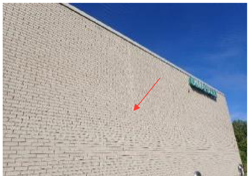
Kuva 100. Vanhan osan julkisivun liikuntasaumamassa sisältää ylemmän ohjearvon ylittävän määrän kadmiumia. Näyte 31.
