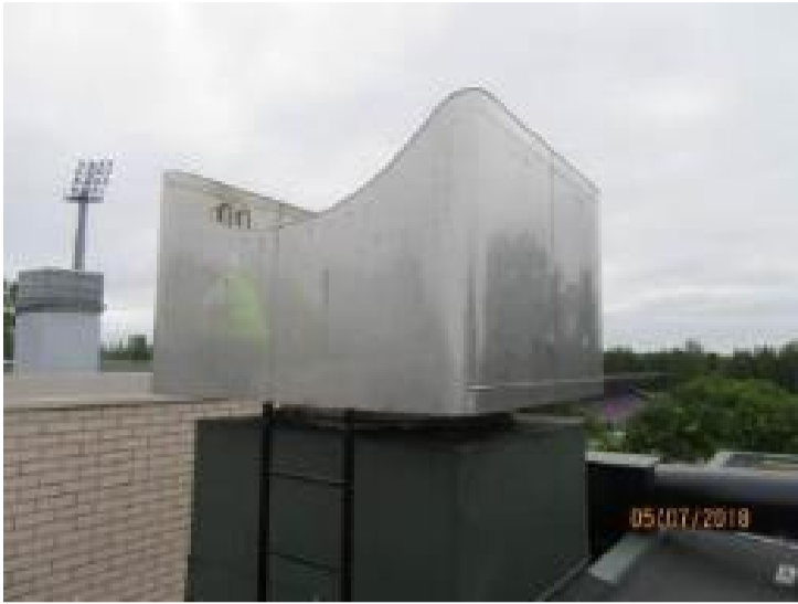
Kuva 225. Ilmanvaihtokoneiden 3TK/PK1, 3TK/PK2, 3TK/PK3 ja 3TK/PK4 yhteinen ulospuhallushajotin
