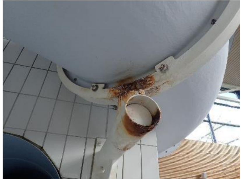
Kuva 143. Vesiliukumäen teräskannakkeessa korroosioaurioita
