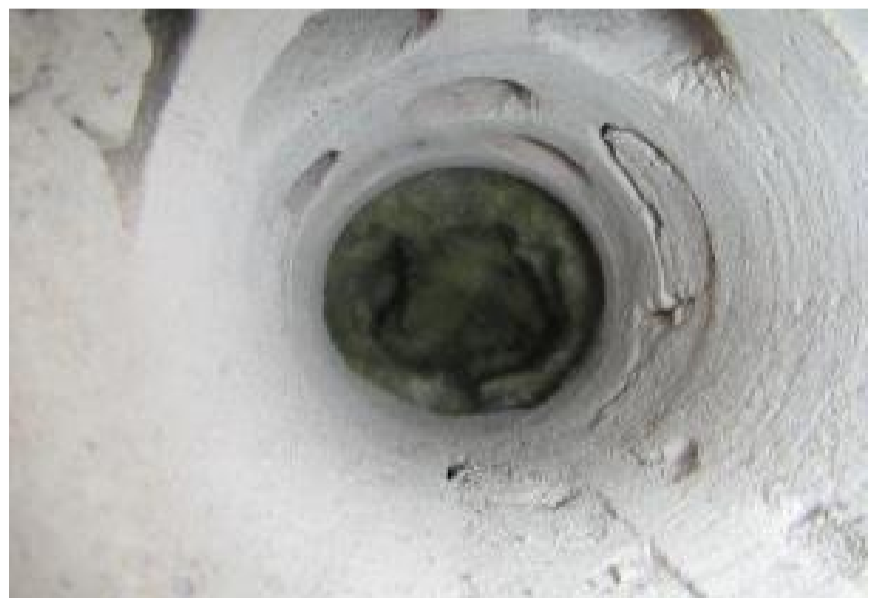
Kuva 20. US6. Kohdalla ei tuuletusväliä tiilimuurauksen ja eristevillan välissä. Näyte M15 kohdalta, heikko viite vauriosta.
