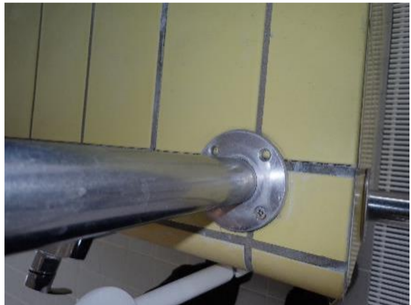
Kuva 133. Hyppykorokkeen kaiteesta puuttuu kiinnitysruuveja
