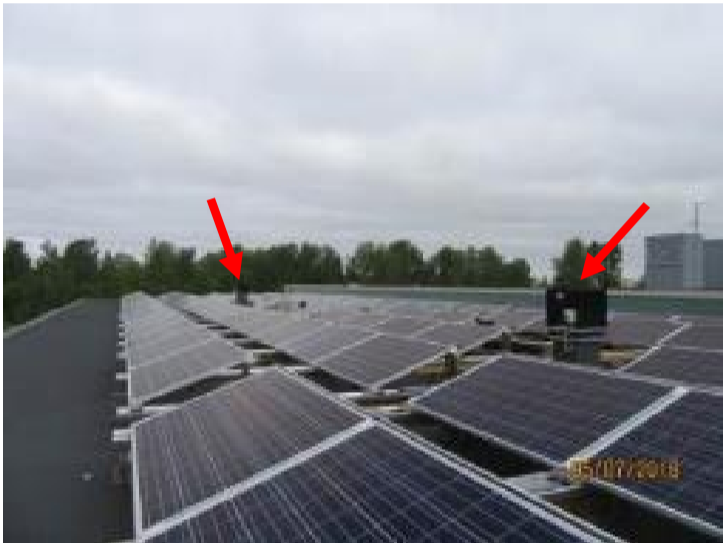
Kuva 223. Laajennusosan allastilan yläosan huippuimurit vuodelta 2016
