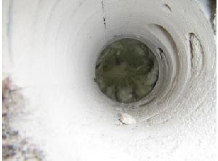
Kuva 16. US4. Kohdalla ei tuuletusväliä tiilimuurauksen ja eristevillan välissä. Näyte M11 kohdalta, viittaa vaurioon.
