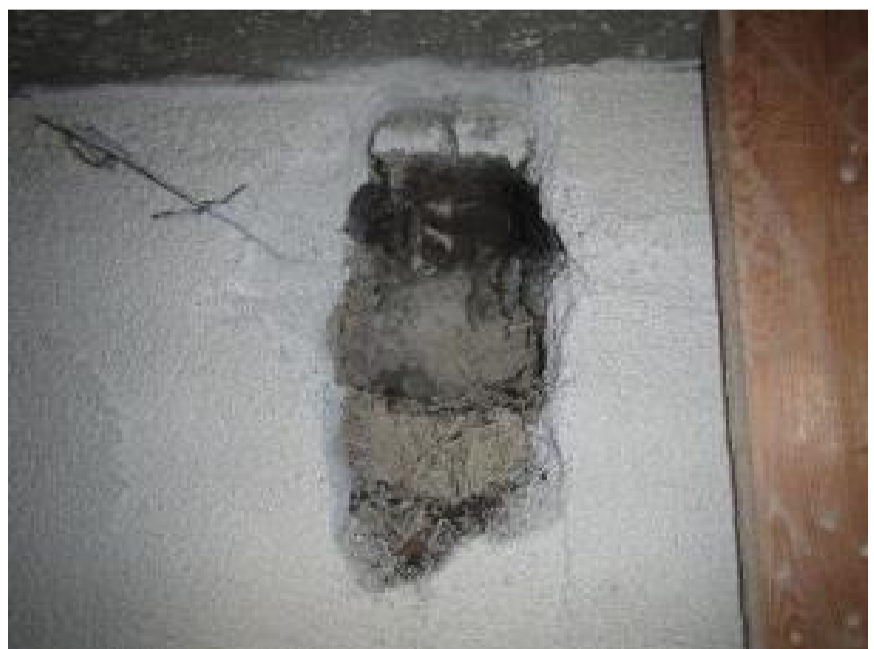
Kuva 44. US17. Kohdalla eristeenä Toja-levyä, korkkia ja villaa. Näyte M4 korkkilevystä, ei viitettä vauriosta.
