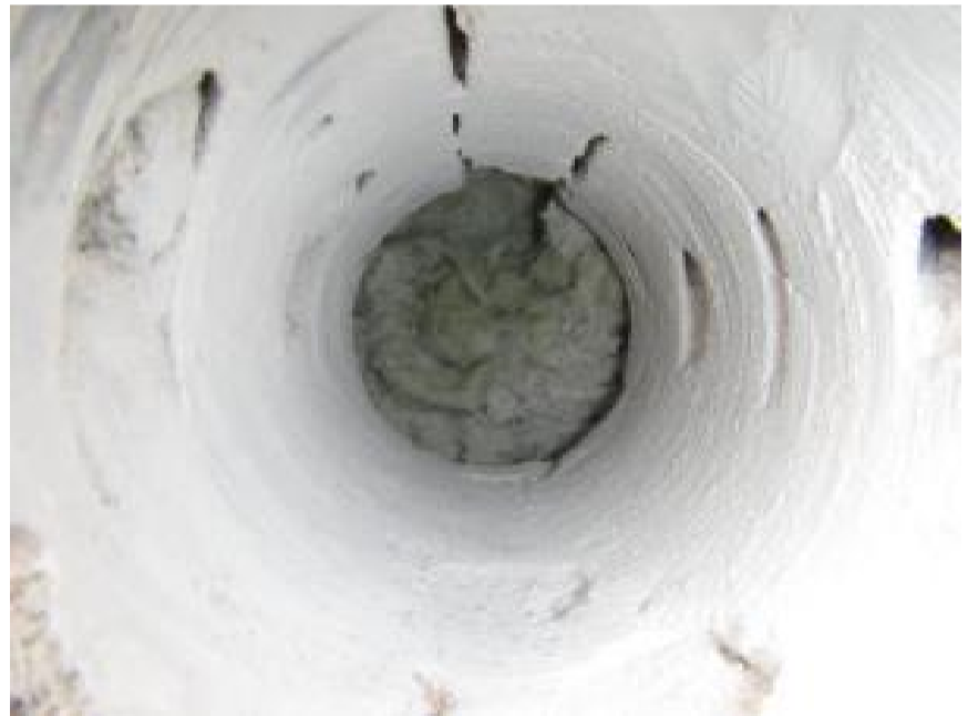
Kuva 12. US2. Kohdalla ei tuuletusväliä tiilimuurauksen ja eristevillan välissä. Näyte M8 kohdalta, viittaa vaurioon.
