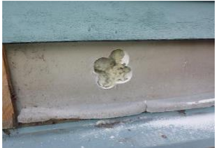
Kuva 34. US12. Tuulensuojalevyn alaosassa kostusvaurioita. Näyte M17 seinän eristevillasta, viittaa vaurioon.
