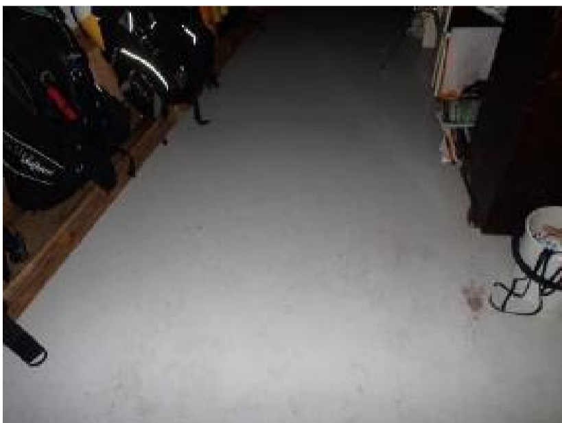
Kuva 96. Tilan 009 lattian harmaa maali sisältää vaaralliseksi jätteeksi luokiteltavan määrän PCB:tä, Näyte 12.
