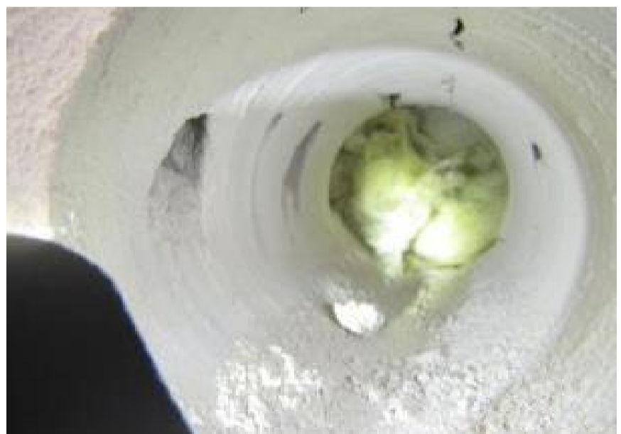
Kuva 14. US3. Kohdalla ei tuuletusväliä tiilimuurauksen ja eristevillan välissä. Näyte M9 kohdalta, ei viitettä vaurioista.
