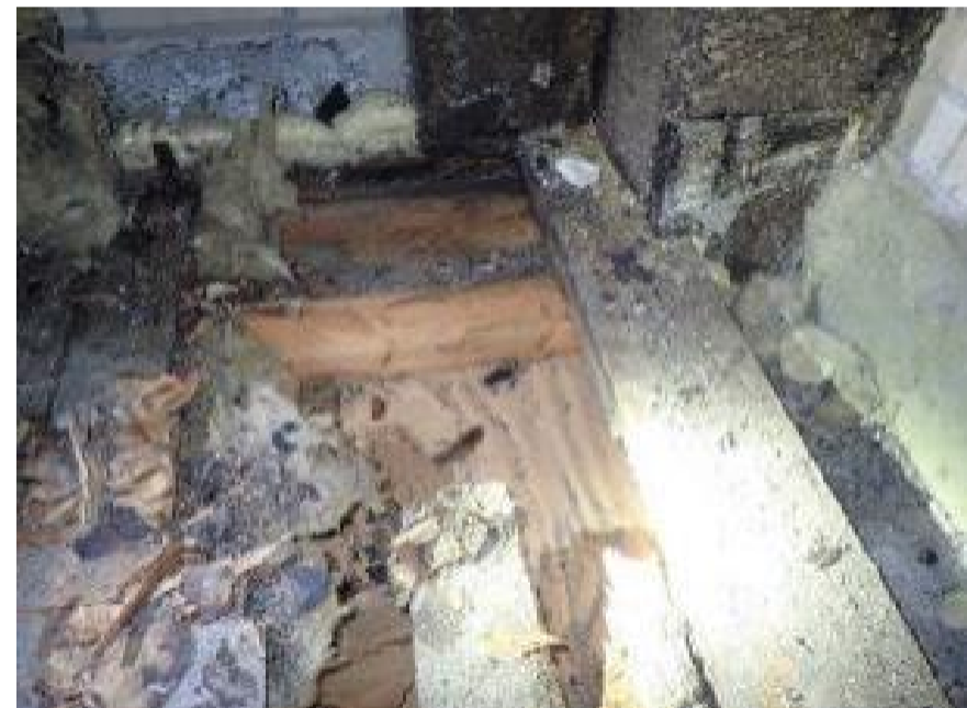
Kuva 58. YP1 Kosteusjäljet ja lahovauriot ovat pääasiassa rakenteen yläpinnassa.
