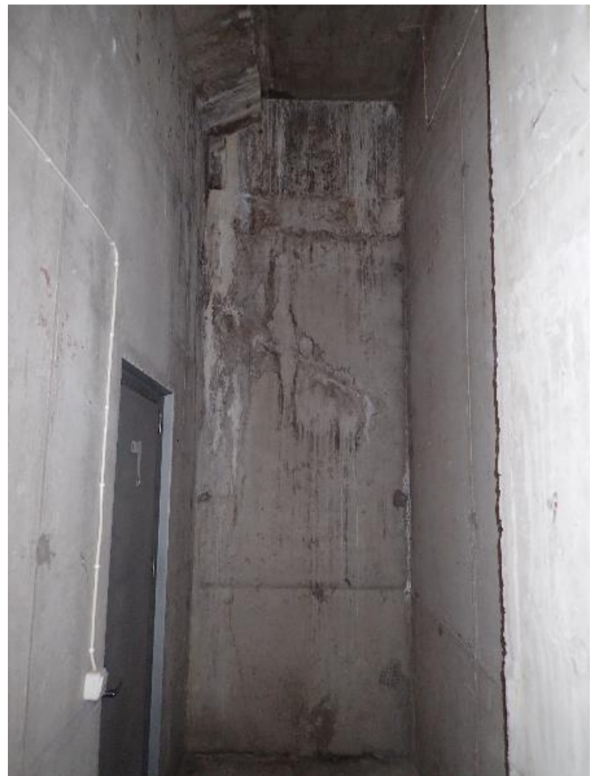
Kuva 137. Toiminta-altaan vesiliukumäen puoleisessa reunassa on vesivuotoa kellaritiloihin
