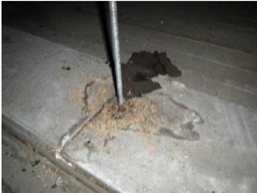
Kuva 55. Kosteusjälkiä lisäkannatuksen läpiviennin kohdalla. Kierretangossa korroosiovaurioita.
