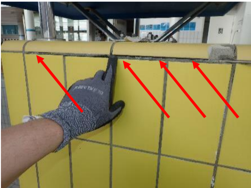
Kuva 132. Korokkeen yläosa on irronnut alustastaan
