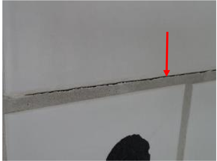
Kuva 109. Altaiden saumalaasteissa havaittiin yksittäisissä kohdin laastin irtoamista laatoista
