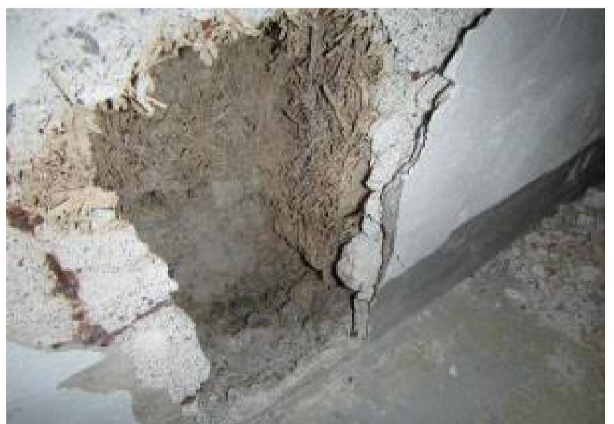
Kuva 38. US14. Sokkelin sisäpinnassa toja-levy, joka jatkuu lattiapinnan alapuolelle ja on kiinni täyttöhiekkakerroksessa. Kohdalla tunkkainen haju. Toja-eristeestä näyte M2, heikko viite vauriosta.
