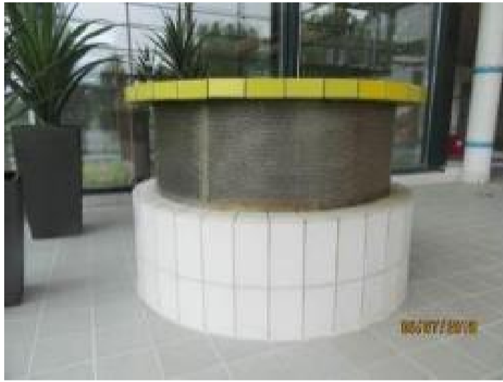
Kuva 234. Vanhemman allastilan poistoilmalaite
