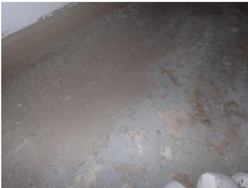
Kuva 97. Kellarin lattiassa oleva ruskea /harmaa lattiamaali ylittää ylemmän ohjearvon ylittävän määrän sinkkiä, Näyte 1, 9, ja 12
