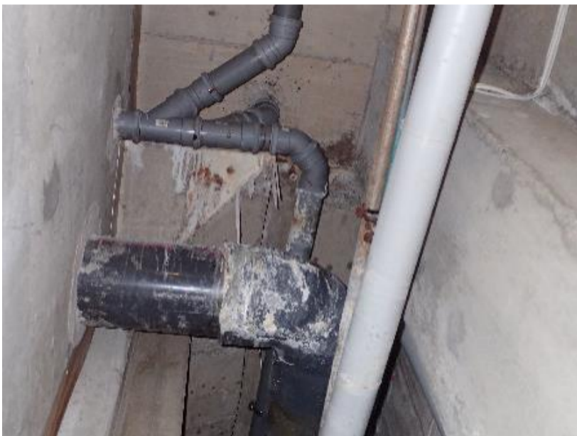
Kuva 136. Virkistysaltaan putkiläpivienneissä on paikoin vuotoa
