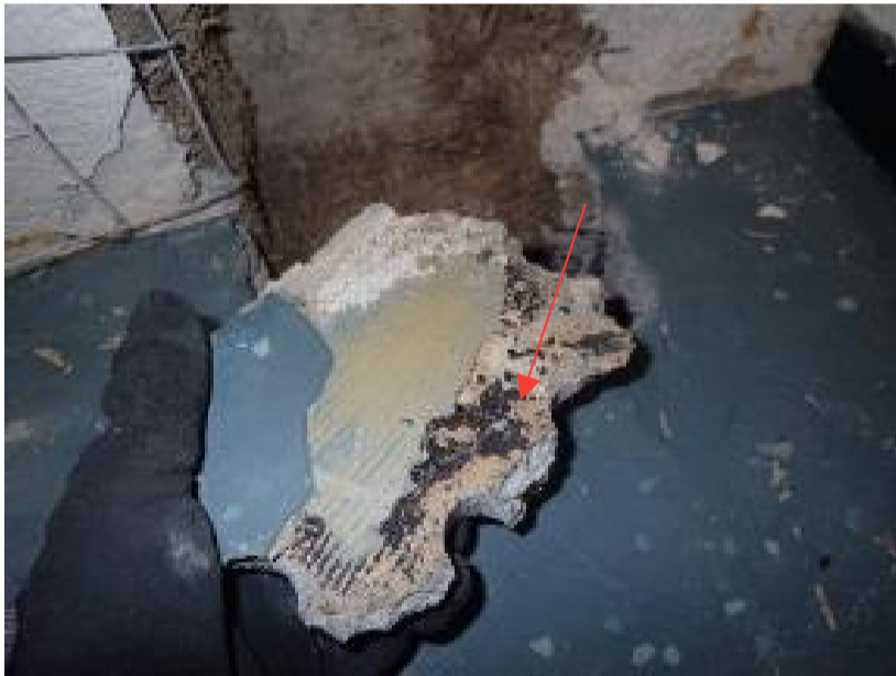
Kuva 89. Taukotilan 101 lattian alkuperäisen pinnoiteen kiinnitysliima sisältää asbestia (antofylliitti). Näyte 14.
