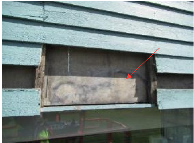
Kuva 90. Ulkoseinän puuverhotuilla osilla paikoin oleva kuitusementti- tuulensuojalevy sisältää asbestia (antofylliitti, krysotiili, krokidoliitti). Näyte 33.
