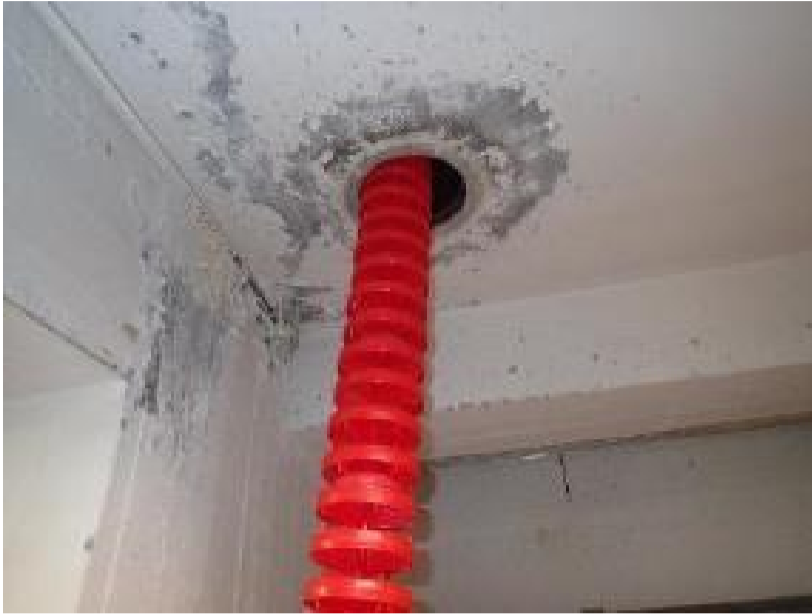
Kuva 120. Altaiden alapuolisissa tiloissa altaiden vuoto/valumavesien aiheuttamia vaurioita
