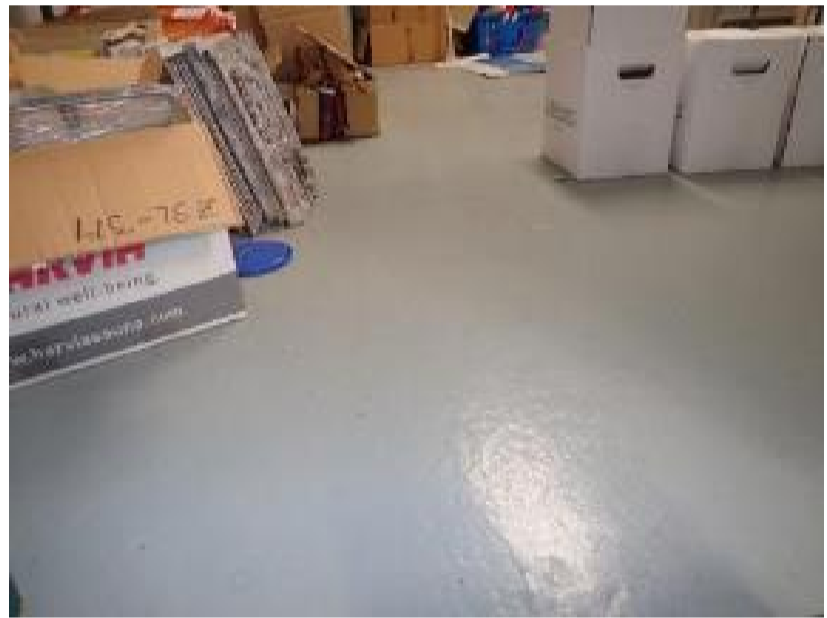
Kuva 95. Väestönsuojan harmaa lattiamaali sisältää vaaralliseksi luokiteltavan määrän PCB:tä. Näyte 9.
