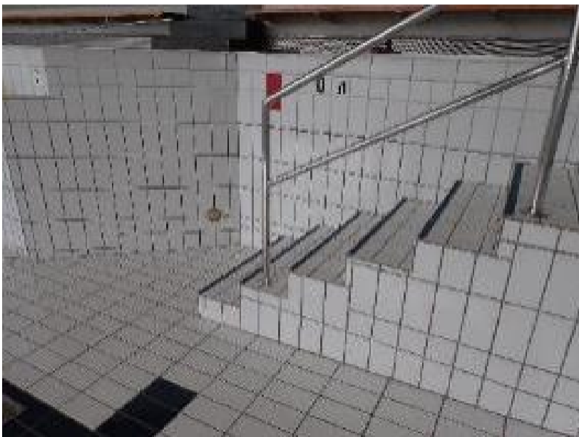
Kuva 122. Kuntoaltaan portaiden kaiteen kiinnitys on heikentynyt
