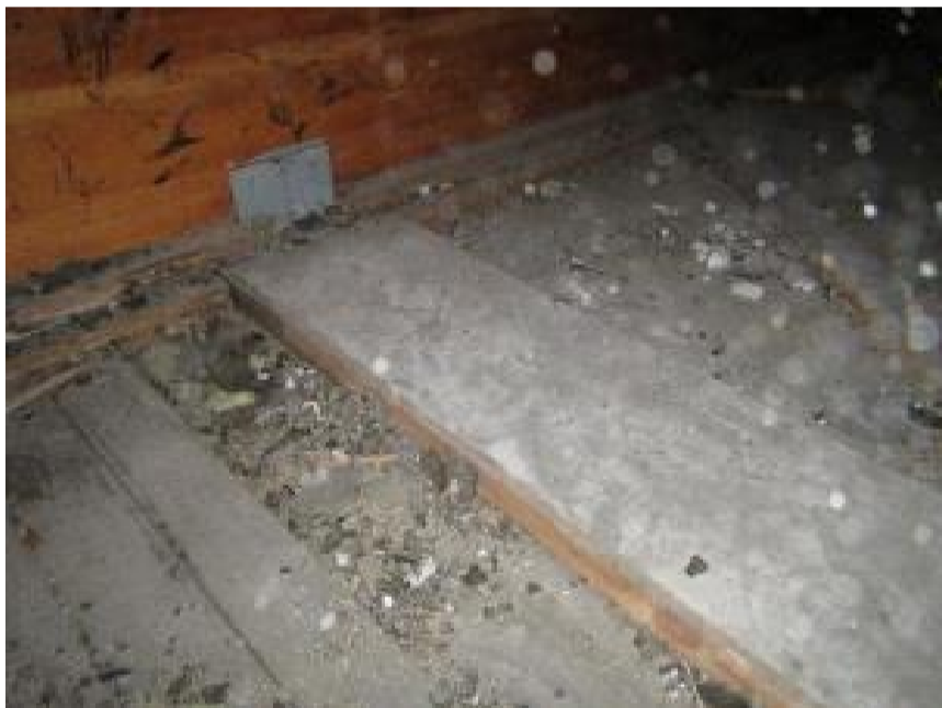
Kuva 63. Rakenneavauskohta YP3. Yläpohjan kantavan rakenteen kohdalle. Kohdalla vain vähän pintapuolisia kosteusjälkiä.
