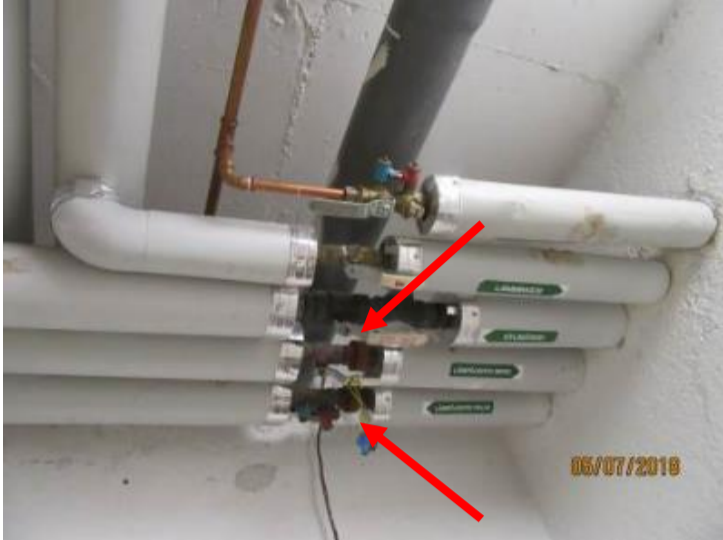
Kuva 185. Lämpöjohtojen sulku- ja linjasäätöventtiilit
