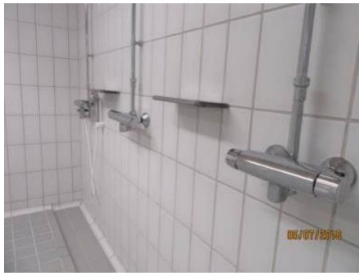
Kuva 196. Vesikalusteet ovat kunnossa
