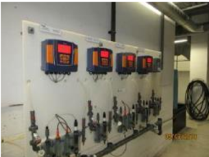
Kuva 258. Ph- ja kloorisäätimet sekä kylmien ja lämpimien altaiden Redox-mitaukset
