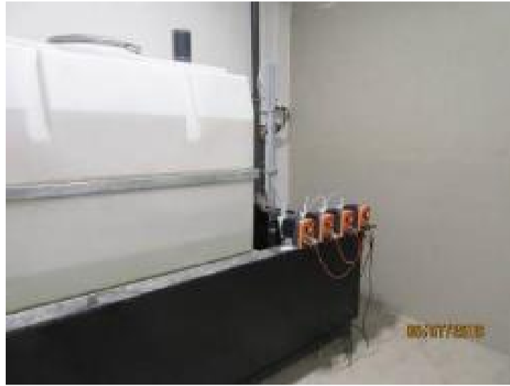
Kuva 255. Natriumhypokloriittisäiliö ja syöttöpumput
