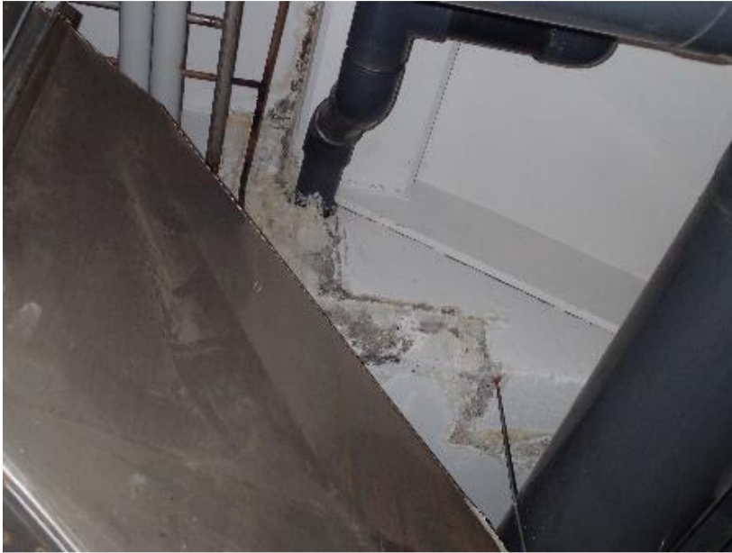
Kuva 138. Toiminta-altaan alapuolella on vuotavia läpivientejä
