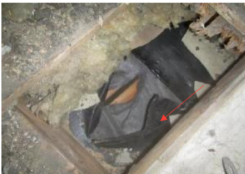
Kuva 65. YP3, kuvassa alimapanana allasosaston sisäkaton harvalauta. Nuolen kohdalla myöhemmin lisätty höyrinsylku. Rakenteessa oleva kuitusementtilevy sisältää asbestia.
