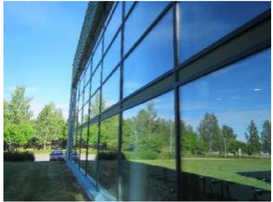
KUVA 46. Yleiskuvaa MEK-ikkunoista. Ulkopuitteet pääosin hyväkuntoiset. Tiivisteet ovat paikoin ravistuneet.
