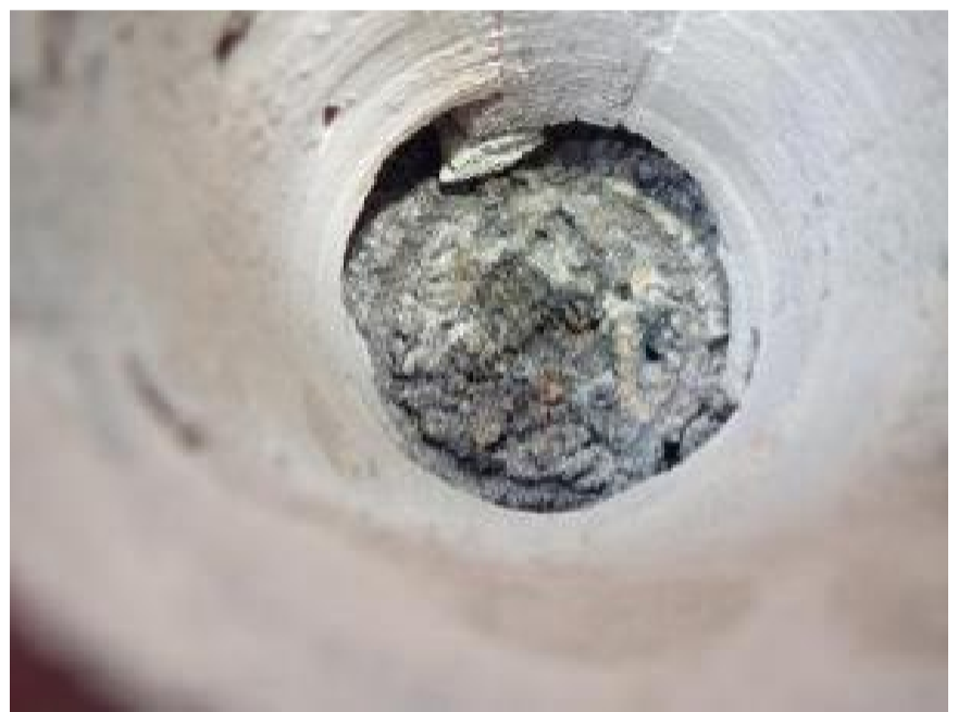
Kuva 30. US10. Kohdalla a ei tuuletusväliä tiilimuurauksen ja korkkilevyn välissä. Näyte M12 kohdalta, heikko viite vauriosta.
