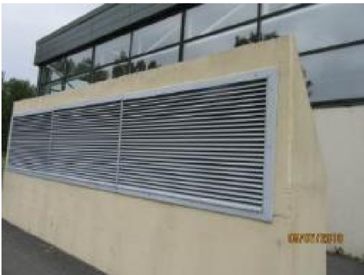
Kuva 227. Laitelin ilmanvaihtokoneiden ulkoilmasäleikkö
