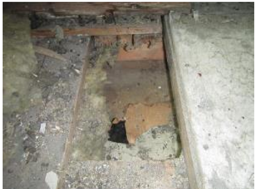
Kuva 64. YP3, avauskohdalla kosteusjälkiä eristekerroksen alla olevassa paperissa.
