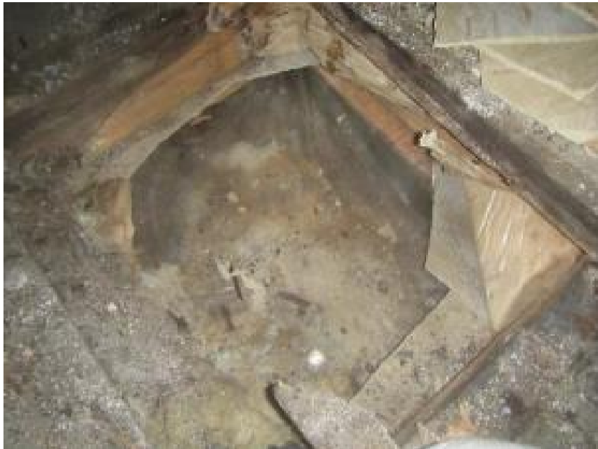
Kuva 61. YP2, Vettä valunut kohdalla sisäpinnalla olevan höyrinsulkumuovin päälle. Rakenteessa oleva kuitusementtilevy sisältää asbestia.
