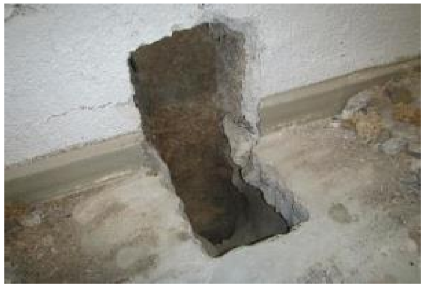
Kuva 36. US13. Sokkelin sisäpinnassa toja-levy, joka jatkuu lattiapinnan alapuolelle ja on kiinni täyttöhiekkakerroksessa. Kohdalla tunkkainen haju. Toja-eristeestä näyte M1, viittaa vaurioon.
