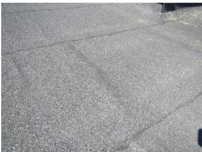
Kuva 75. Katteessa on paikoin pientä kupruilua.
