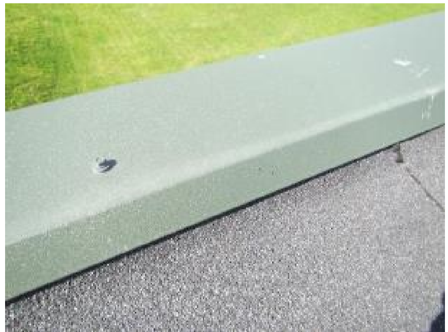
Kuva 80. Reunapellityksen ovat asianmukaiset. Ulkoseinällä pellin alla on myrskypelti.
