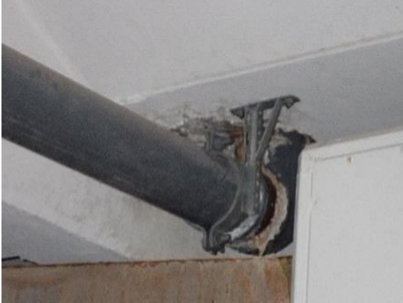
Kuva 134. Toiminta-altaan putkiläpivienneissä on paikoin vuotoa
