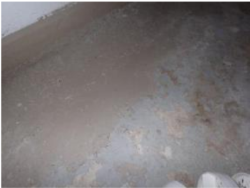
Kuva 94. Kellarin lattiassa oleva ruskea/harmaa lattiamaali sisältää vaaralliseksi jätteeksi luokiteltavan määrän PCB:tä, Näyte 1.
