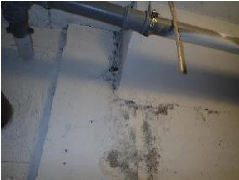
Kuva 118. Vuotavia altaiden betonirakenteiden saumojä
