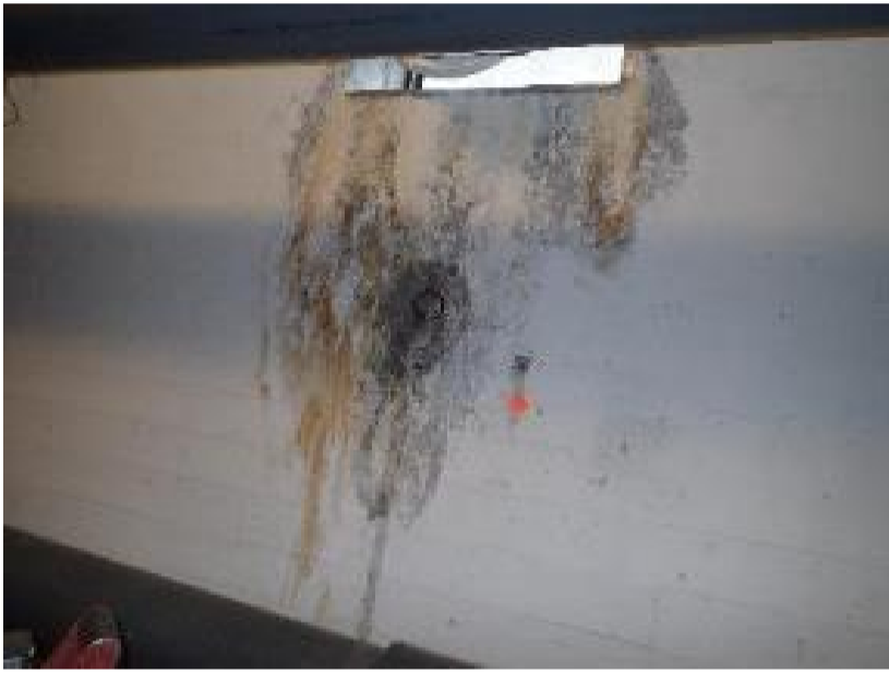
Kuva 112. Kuntoaltaan ikkunoiden kohdilla on vesivuotoa altaiden ulkopuolelle useiden ikkunoiden kohdalla.
