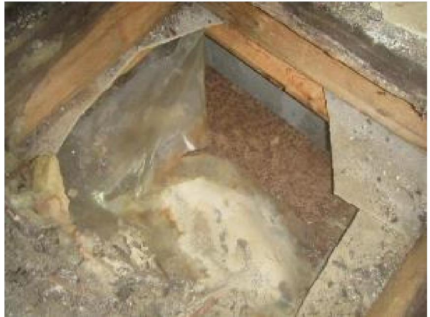
Kuva 62. YP2 Höyrinsulkumuovia ei ole kiinnitetty kunnollisesti, kohdalla ilmavuotoreitti. Kuvassa alla ruostunut IV-kanavan yläpinta.
