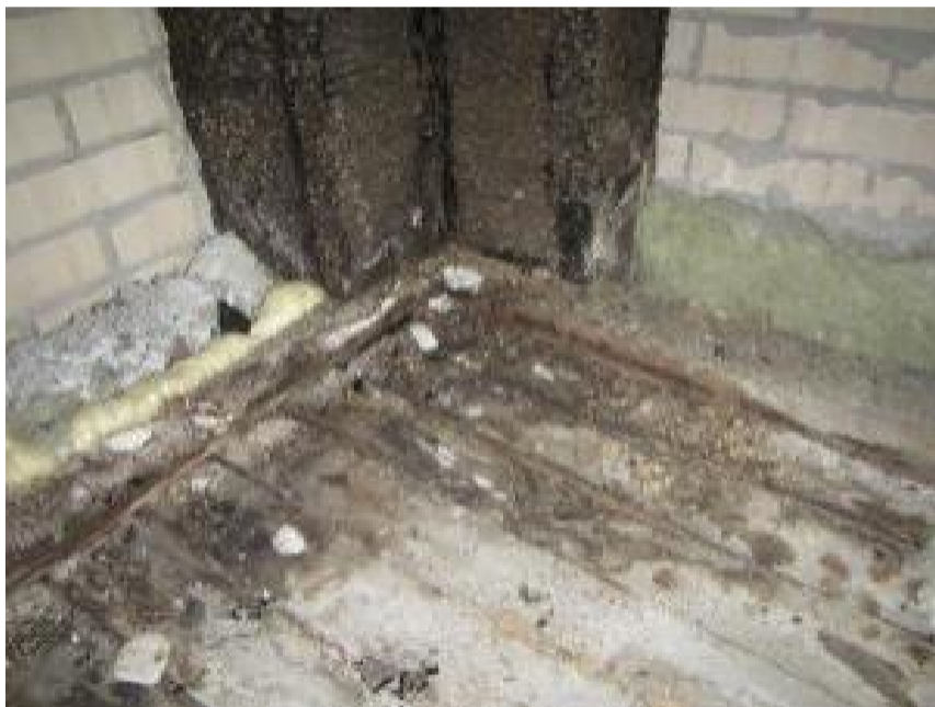
Kuva 57. Rakenneavauskohta YP1 ulkonurkkaukseen. Kohdalla merkittävää lahoa.
