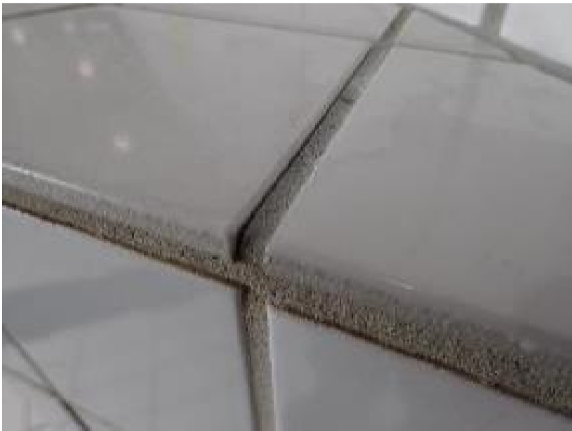
Kuva 106. Laatoitusten saumalaastit ovat pieniltä osin syöpyneet ja irronneet.
