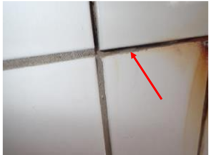
Kuva 107. Altaiden laattasaumauksia on paikkailtu. Kuntoaltaassa paikkasaumaus oli jäänyt tekemättä auki sahattuihin saumoihin.
