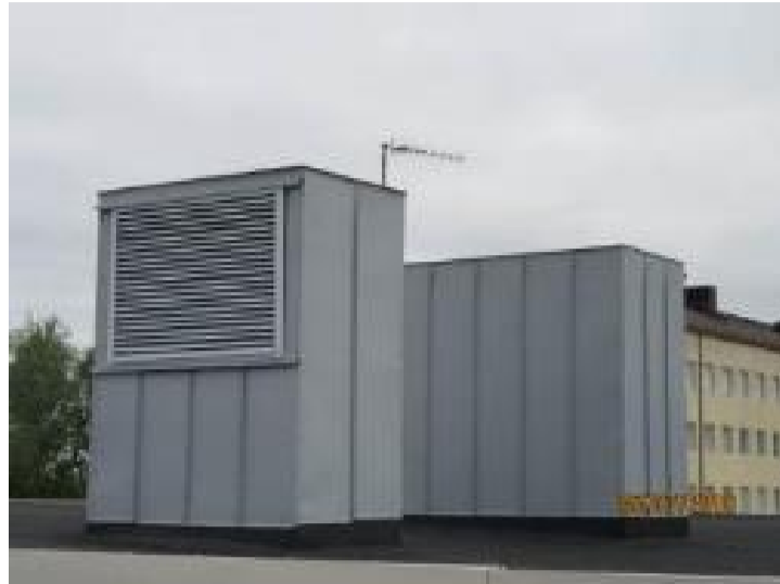
Kuva 226. Ilmanvaihtokoneen 3TK/PK5 ulko- ja jäteilmasäleiköt
