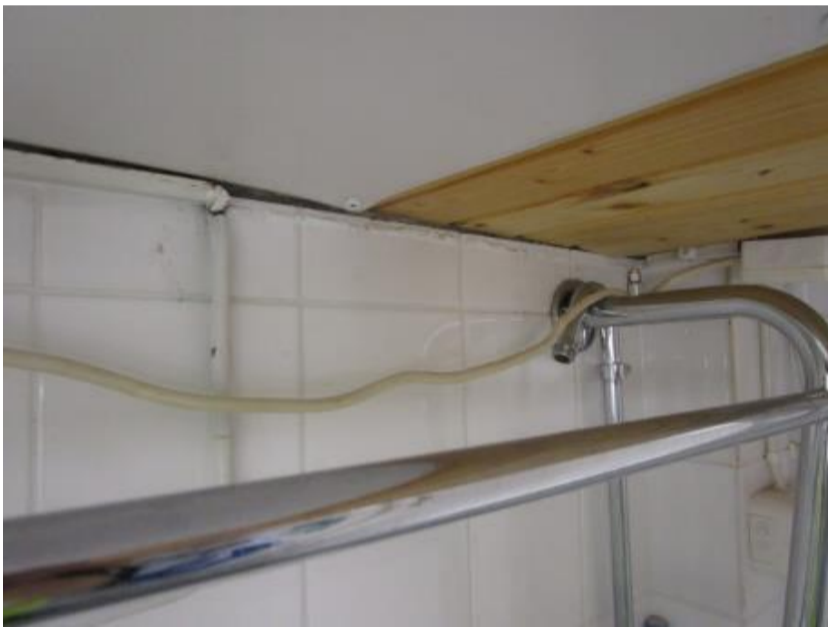
Kuva 156. Pesutilan siivouskomerossa kaapeli irrallaan.
