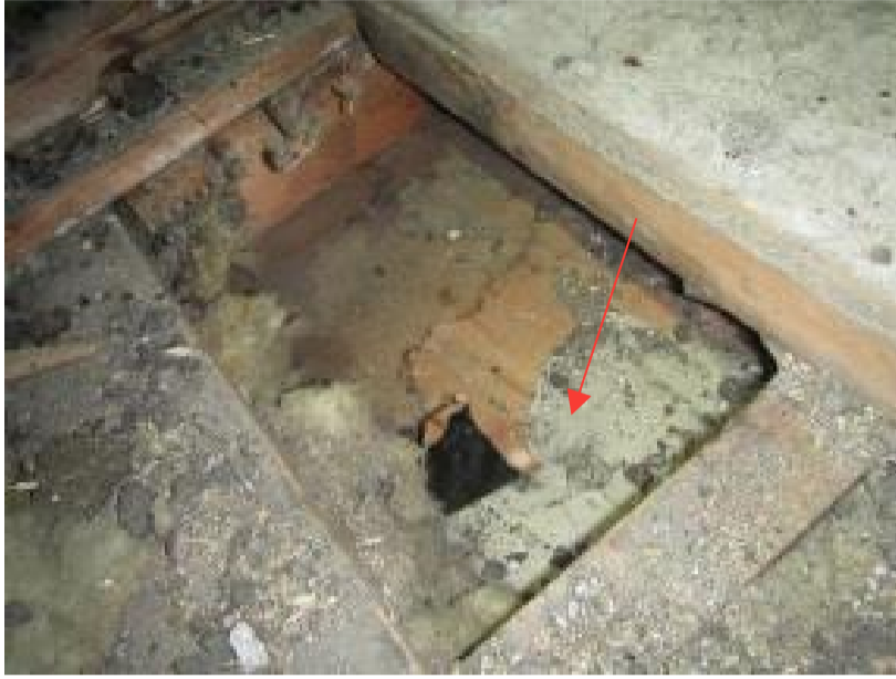
Kuva 91. Vanhan rakennuksen osan yläpohjarakenteessa oleva kuitusementtilevy sisältää asbestia (antofyllitti, krysotiili, krokidoliitti). Näyte 34.
