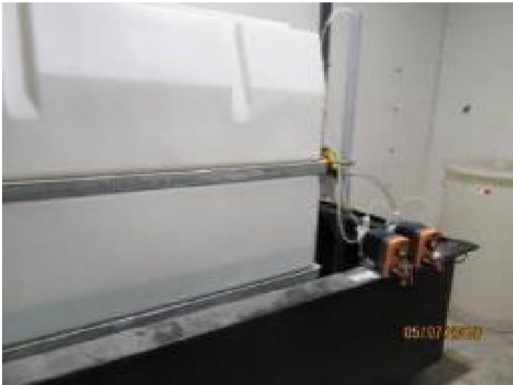
Kuva 256. Rikkihapposäiliö ja Ph-pumput kylmään ja lämpimään kiertoon
