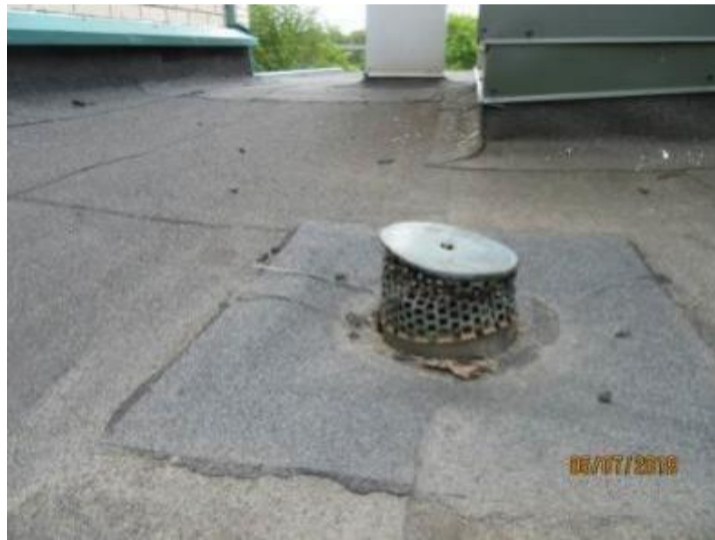
Kuva 212. Kattokaivon roskasihti on vaurioitunut
