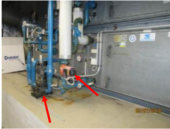
Kuva 192. Ilmanvaihtokoneen lämmityksen ja lämmön talteenoton pumput
