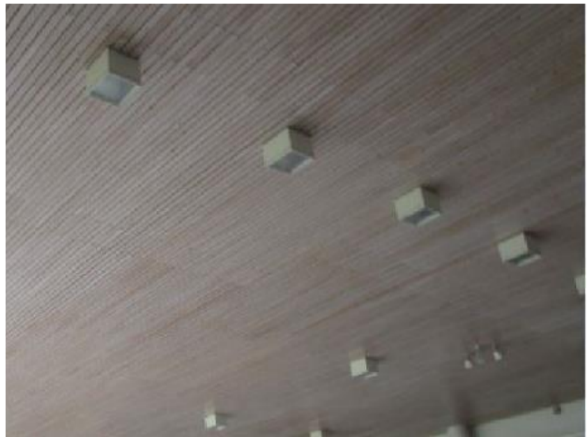
Kuva 161. Näkymä allasosaston valaisimista.
