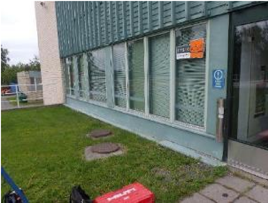
KUVA 45. Yleiskuvaa MSE-ikkunoista. Ulkopuitteissa havaittavissa on ravistumista.
