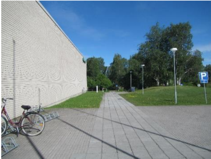
Kuva 1. Kuva rakennuksen etusivulta. Kulkualueet ja nurmipinta ovat tasaiset, seinän vierellä nurmialue on paikoin kaadolla rakennusta kohti.
