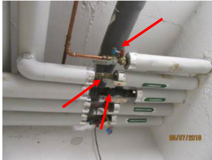
Kuva 194. Vesijohtojen sulku- ja linjasäätöventtiilit
