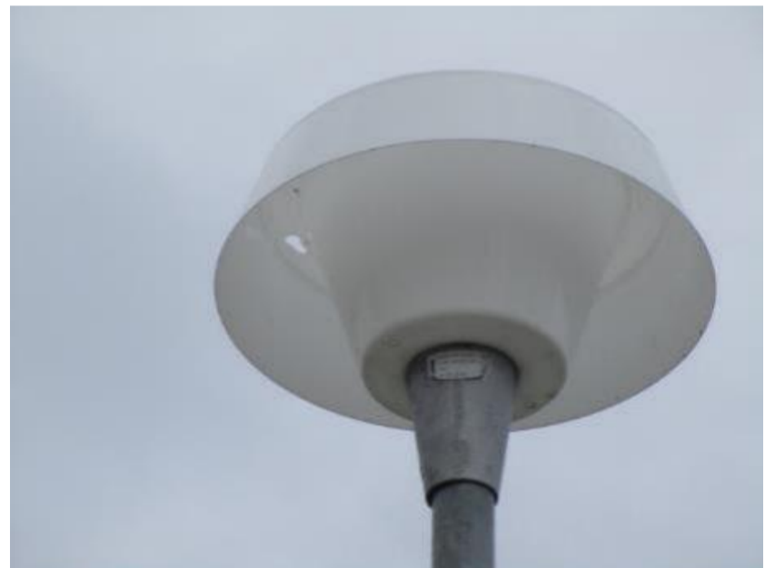
Kuva 145. Pylväsvalaisimia, suojakupu puuttuu.
