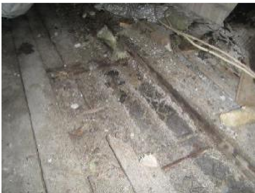
Kuva 59. Rakenneavauskohta YP2 rakennuksen etusivulla. Kohdalla merkittävää lahoa.
