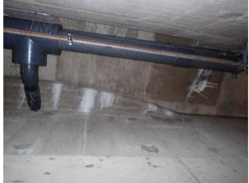
Kuva 135. Virkistysaltaan putkiläpivienneissä on paikoin vuotoa
