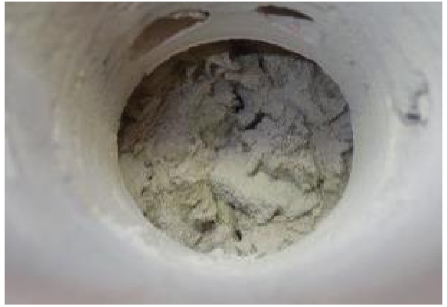
Kuva 28. US9. Kohdalla ei tuuletusväliä tiilimuurauksen ja eristevillan välissä. Näyte M10 kohdalta, heikko viite vauriosta.
