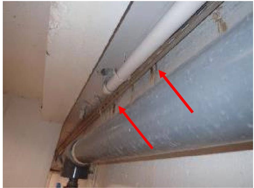
Kuva 119. Vuotavia altaiden betonirakenteiden saumojä
