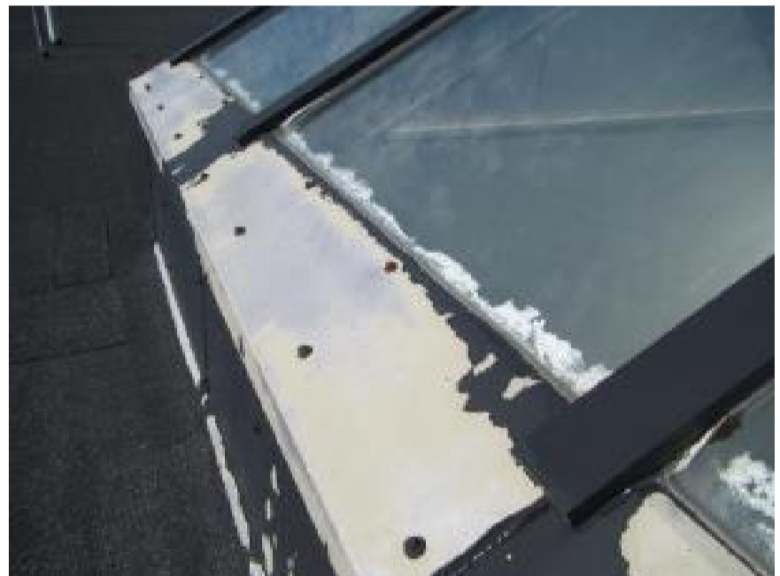
Kuva 74. Kattoikkunoiden lasien väliin on kertynyt tiivistynyt kosteutta. Sisäilpinnoilla on vähäisiä kosteusjälkiä.
