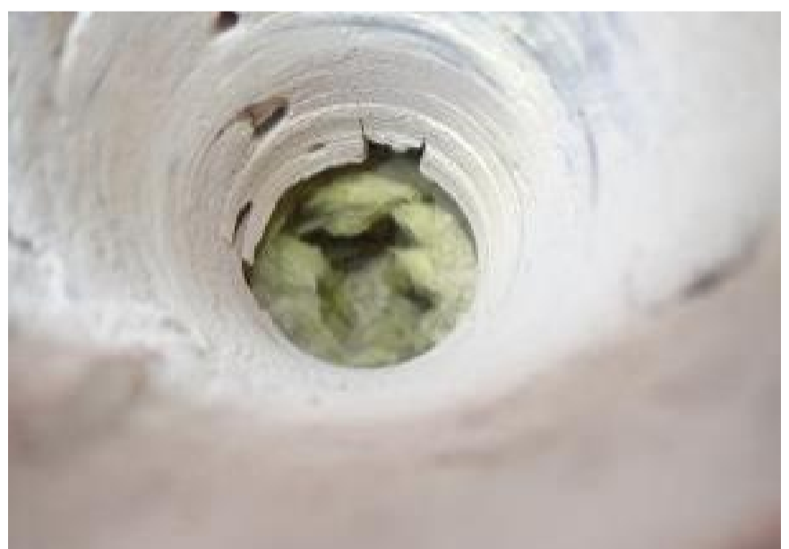
Kuva 32. US11. Kohdalla ei tuuletusväliä tiilimuurauksen ja eristevillan välissä. Näyte M16 kohdalta, viittaa vaurioon.
