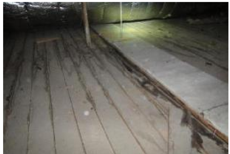
Kuva 54. Paikallisia kosteusjälkiä yläpohjan kantavien palkistojen vierustoilla.
