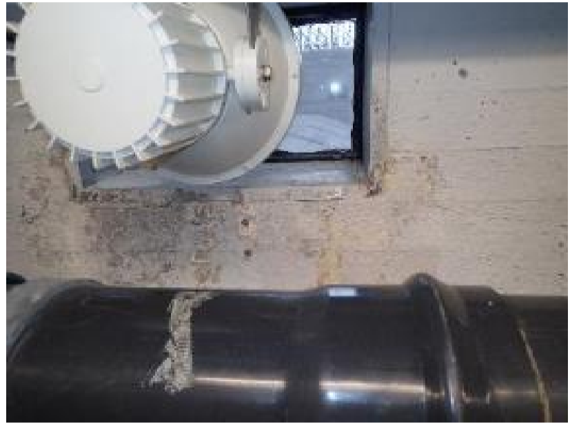
Kuva 113. Kuntoaltaan ikkunoiden kohdilla on vesivuotoa altaiden ulkopuolelle lähes kaikkien ikkunoiden kohdalla.
