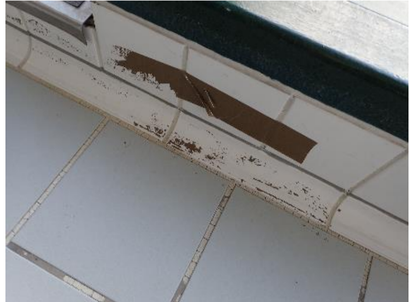
Kuva 127. Paikoin laattasaumaukset olivat huonokuntoisia. Kuva toiminta-altaan viereltä kävelytasolta
