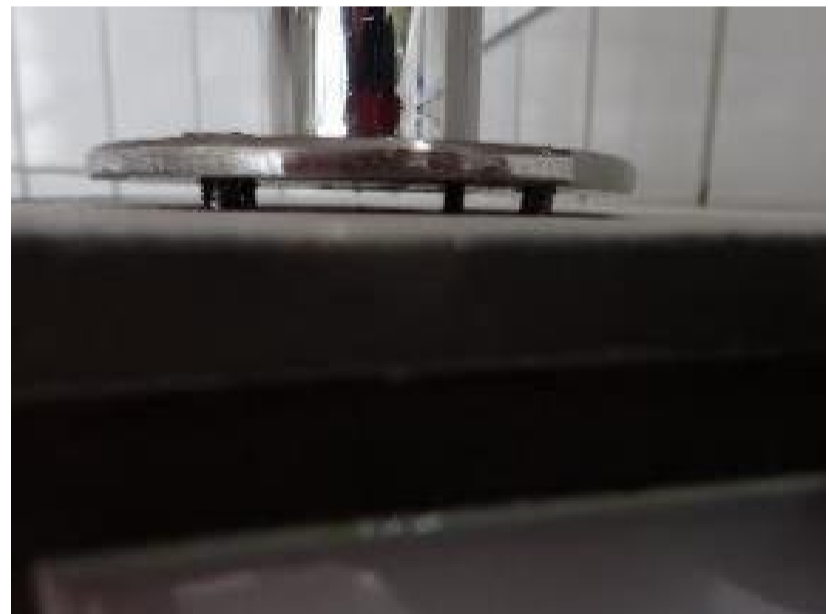
Kuva 123. Kaiteen kiinnitys porrarakenteeseen on löystynyt ja kaide pääsee heilumaan
