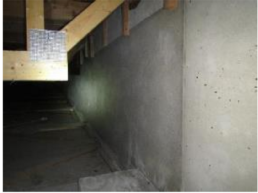
Kuva 92. Vanhan rakennuksen osan yläpohjatilassa olevan palokatkoseinän kuitusementtilevytykset sisältävät asbestia (antofyllitti, krysotiili, krokidoliitti). Näyte 37.
