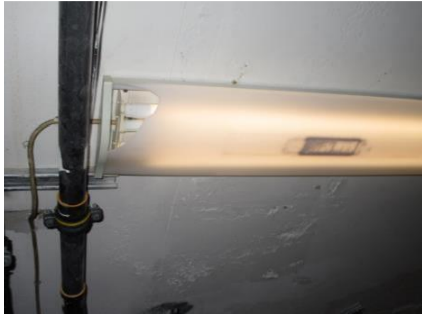
Kuva 159. Valaisinkupuja on rikki, kellari.
