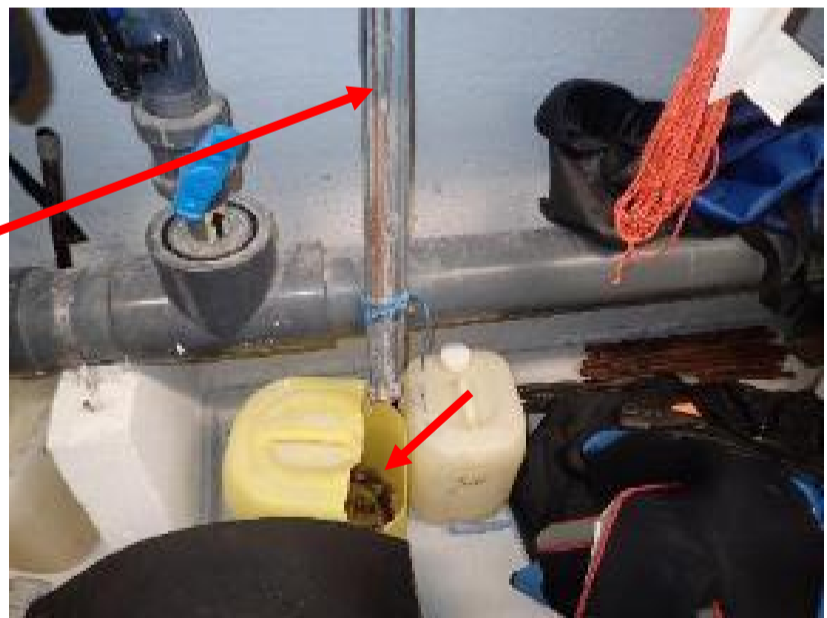
Kuva 115. Yhden kuntoaltaan ikkunan kohdalle oli tehty vuotovesille veden ohjauskouru, josta vedet ohjattiin kourulla kanisteriin.
