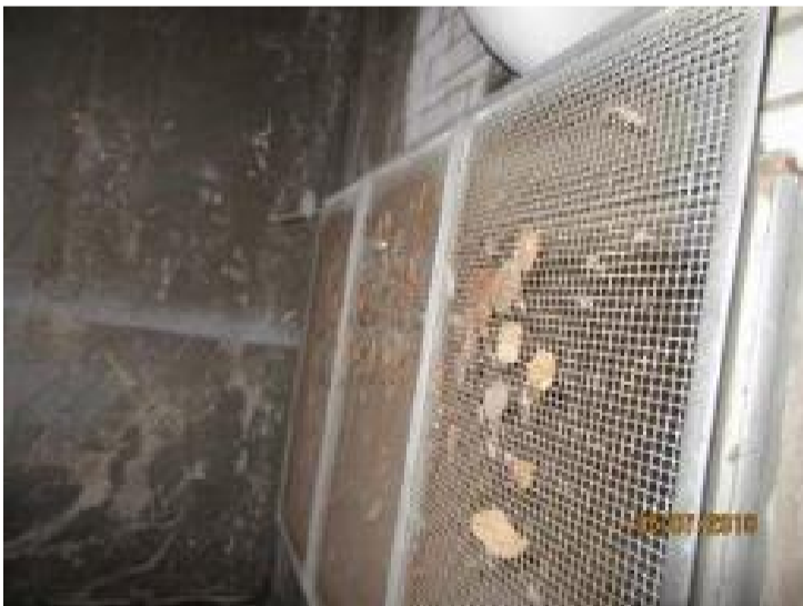
Kuva 229. Ilmanvaihtokoneiden ulkoilmakammio kellarissa
