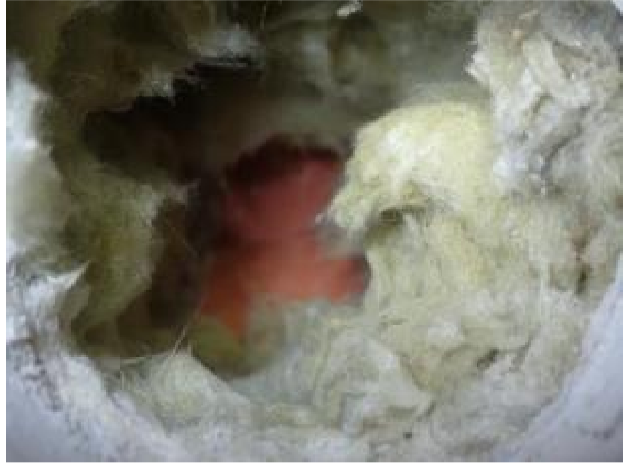
Kuva 22. US7. Kohdalla sisäverhouksena tiili. Ulkopinnassa tuulensuojalevy. Näyte M6 kohdalta, heikko viite vauriosta.
