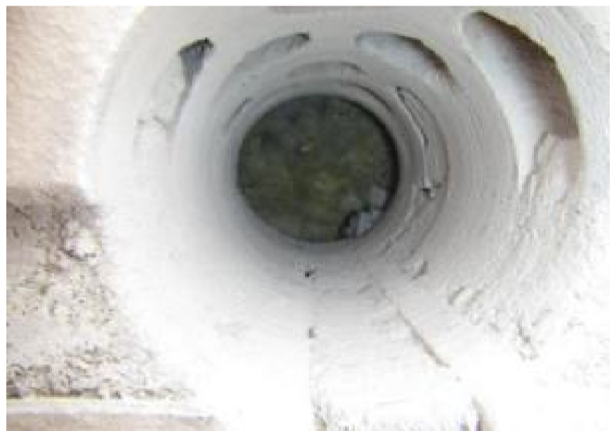
Kuva 18. US5. Kohdalla ei tuuletusväliä tiilimuurauksen ja eristevillan välissä. Näyte M13 kohdalta, heikko viite vauriosta.
