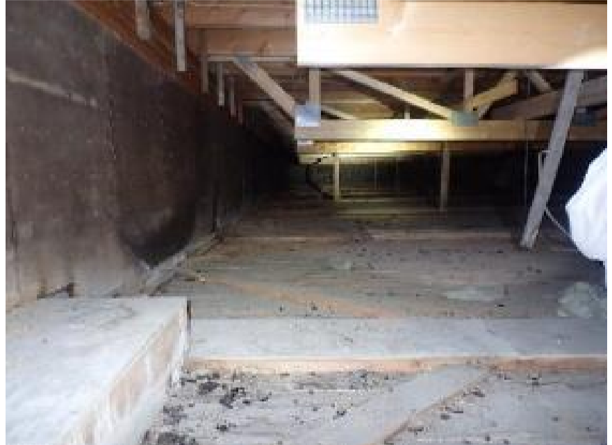
Kuva 50. Yleiskuvaa yläpohjatilasta. Vasemmalla haljennut pääkannatinpalkki, joka on vahvistettu molemminpuoleisella vaneroinnilla.
