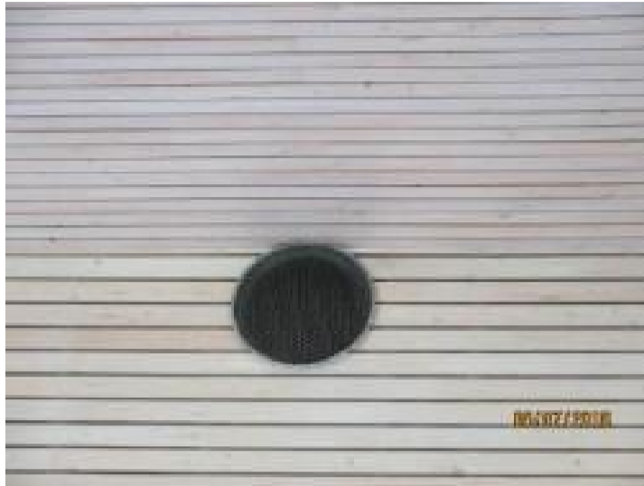
Kuva 232. Vanhemman allastilan poistoilmalaite tilan yläosassa
