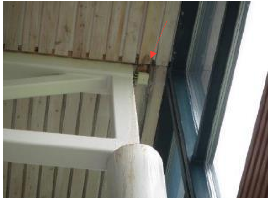
Kuva 84. Harvalaudoituksissa kosteusjälkiä sähköasennuksien kohdalla.
