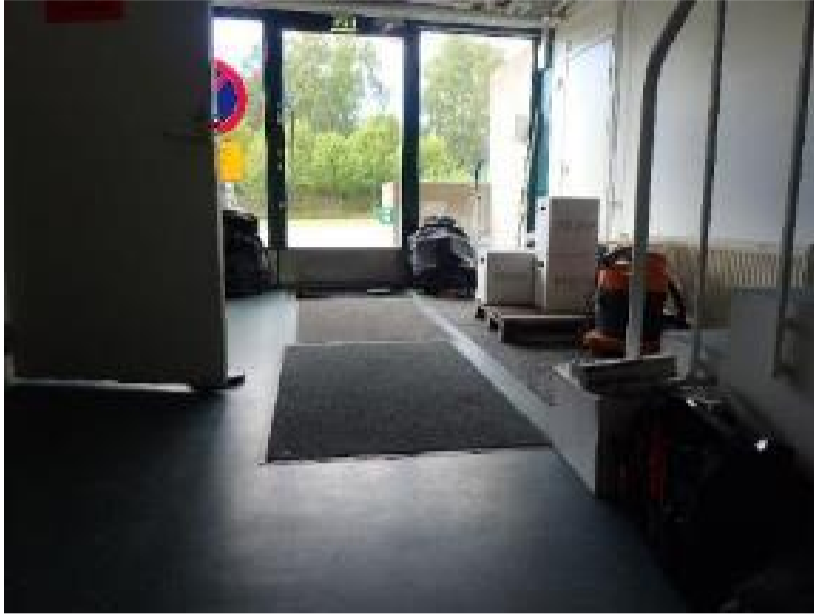
Kuva 101. Ensimmäisen kerroksen käytävän seinämaali sisältää ylemmän ohjearvon ylittävän määrän sinkkiä, Näyte 16.
