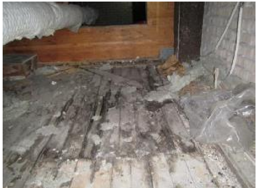
Kuva 52. Yläpohjarakenteessa on useilla kohdilla todennäköisesti rakenteeseen kondensoituvan kosteuden aiheuttamia kosteusjälkiä/ lahoa.
