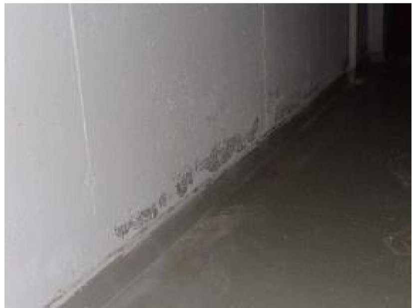
Kuva 98. Kellarin ulko- ja väliseinien valkea maali sisältää ylemmän ohjearvon ylittävän määrän sinkkiä. Näyte 2, 5, 10, 11, ja 30.
