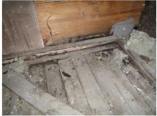
Kuva 14. Liimapuupalkkien alimmista lamelleista 2-3 oli yleisesti lahovaurioituneet.
