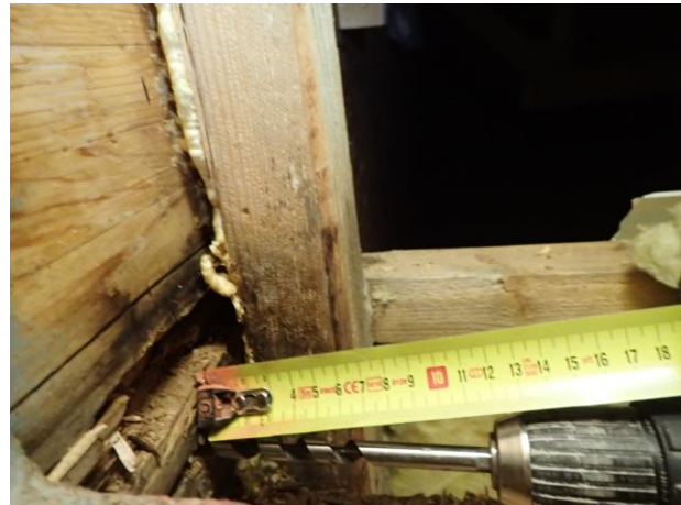
Kuva 20. Lahovauriot ulottuvat arviolta 10 cm syvyyteen. Porakoneen terä 22cm pitkä, "terve" puu tavoitettiin kuvan mukaisesta syvyydestä.
