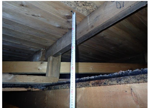
Kuva 4. Uusi yläpohjan vesikattorakenne on tehty vanhan päälle ja toimii lisäkuormana.
