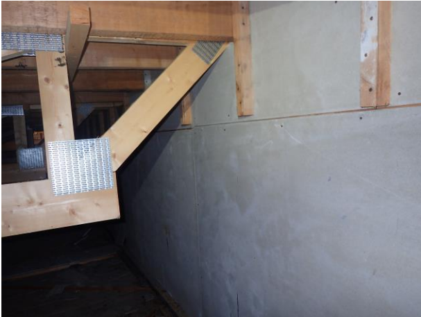
Kuva 13. Palkki 4 oli paloeristetty molemmin puolin mineriittilevyllä, joka sisältää asbestia. Palkkia ei voitu tarkistaa.
