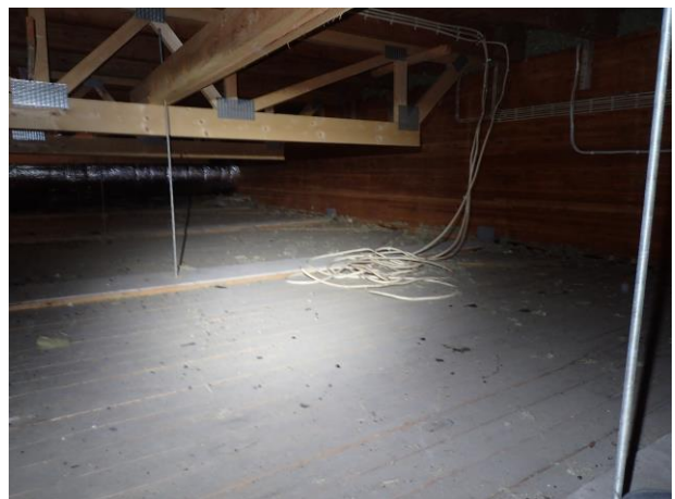
Kuva 6. Alakattorakenteen kannatusta on jouduttu vahvistamaan riiputtamalla niitä ristikoilla ja vetosauvoilla.
