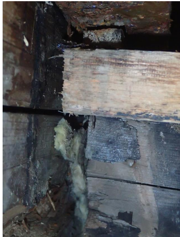
Kuva 22. Lahovaurio ulottuu alaslaskuelementtien kannatukseen sekä kannakoinnit ovat ruostuneet.
