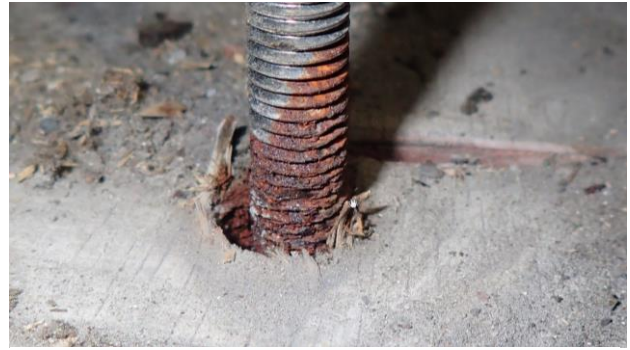
Kuva 8. Alakattorakenteen vetotangot ruostuneet läpivientikohdista paikoin. Jännityskorroosio riski ja henkilövaara. Vetotangot tulee vaihtaa.
