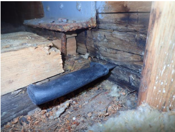
Kuva 15. Palkissa 1, sisäkaton yläpohjaan noston osalta kattopalkeissa kriittisiä lahovaurioita .
