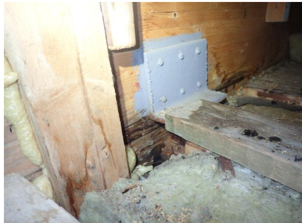
Kuva 16. Palkissa 2 kuvan 15 vastakkaisella puolella nähtävissä vastaava lahovauriota.
