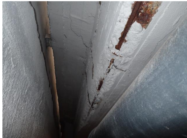
Kuva 18. Mastopilareihin tukeutuva ja niitä jäykistävä kellaritilan betonipalkin teräskorroosioaurio. Vauriot korjattava.
