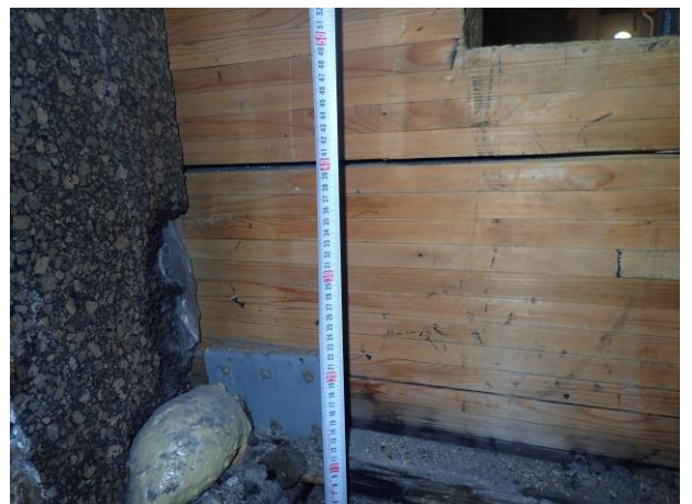
Kuva 12. Levyvahvistetun palkin halkeama on näkyvillä palkin ulokeosalla vahvistuksen ulkopuolella. Vahvistussuunnitelmaa ei ollut saatavilla eikä vahvistussyttä ole tiedossa.
