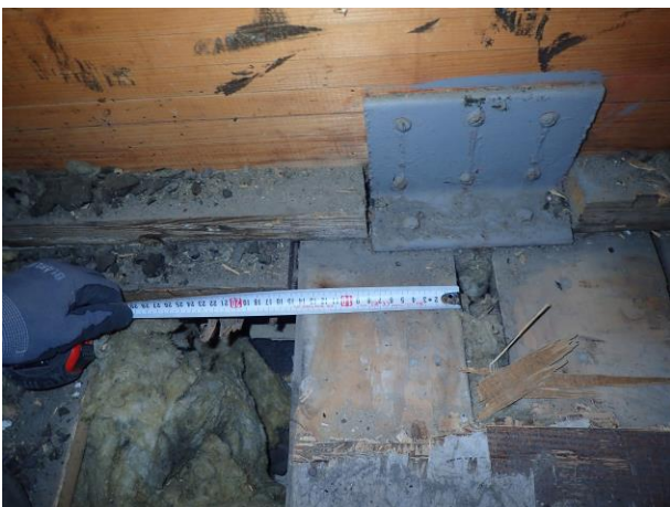
Kuva 5. Alakattorakenne on riiputettu liimapuupalkkien kohdalla kulmaraudalla palkin kyljestä. Kulmaraudat ja niiden kiinnikkeet ruostuneet paikoin.
