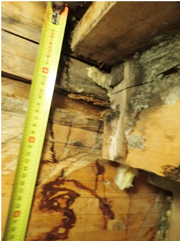
Kuva 21. Lahovaurioalue alakaton sisäännoston kulmassa. Pääkannatin ja ympäröivät rakenteet lahovaurioituneet.
