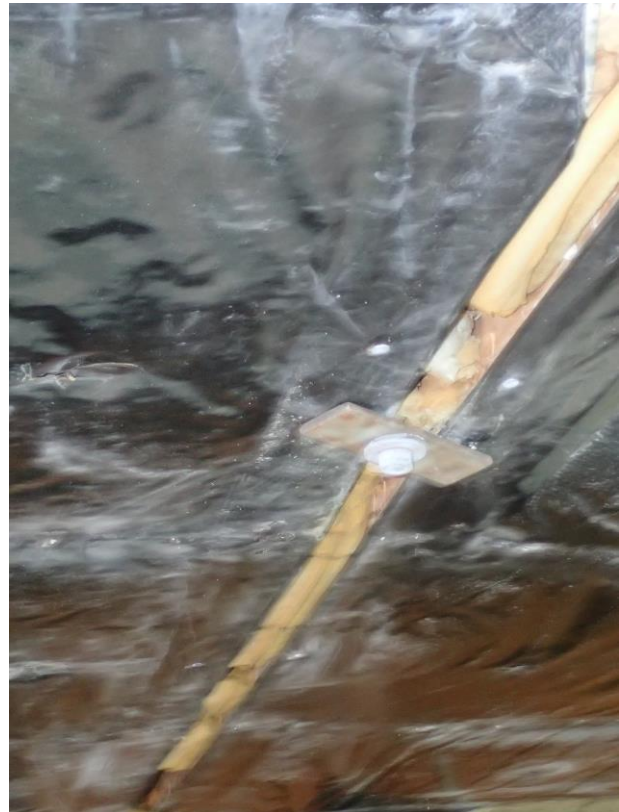
Kuva 24. Alaslaskun kierretankojen alapään liitoksesta uupuu lukkomutteri. Mutterikiinnitys aivan kierretangon päässä, voi löystyä irti.
