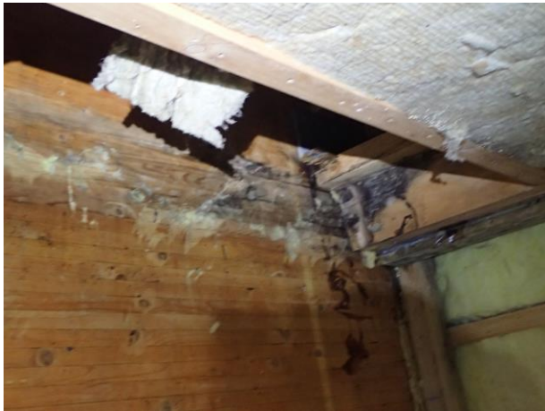
Kuva 19. Sisäkaton korotusosa yläpohjatilassa, liimapuupalkin kylki lahovaurioitunut sisäännoston kulmakohdista.
