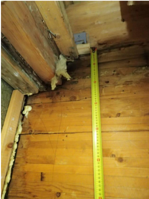
Kuva 23. Pääkannattimet olivat halkeilleet katon sisännostojen osalla. Halkeamien syvyys noin 40 mm ... 70 mm.
