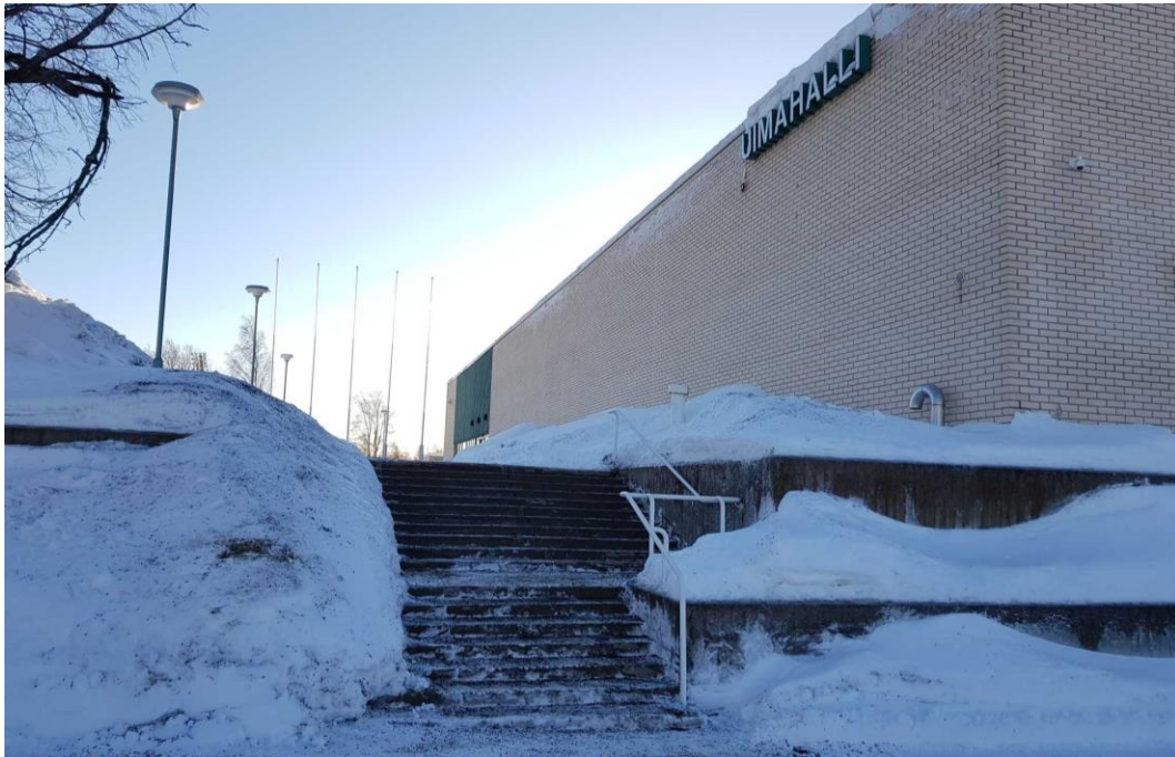
Meripuistokadun puolella sijaitsevalta pysäköintialueelta johtaa uimahallin sisäänkäynnin tasalla sijaitsevalle eduspihalle kaksiosainen leveä portaikko, jota rajaavat betonirakenteiset, lautamuottipin- taiset terassit. Portaat ja terassit ovat säilyneet pääpiirteissään alkuperäisessä asussaan. Putkikaide lienee lisätty myöhemmin.
