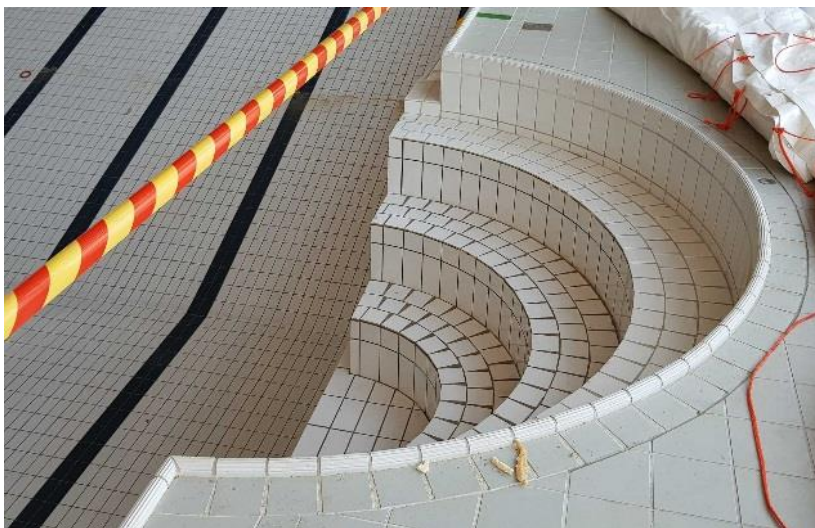
Vuoden 1997 peruskorjauksessa puolipyöreä syvennys on säilytetty. Laatoituksen yksityiskohdat poikkeavat hieman alkuperäisestä, kaarevat vaakapinnat on korjauksen yhteydessä laatoitettu leikkaamattomilla laatoilla, mikä näyttää kömpelöltä, kun saumoista muodostuu kiilamaisia. Alun perin laatoitus oli tehty huolellisesti viimeistellen siten, että pystysaumot jatkoivat yhtenäisinä ylhäältä alas saakka (vertaa vanha kuva). Pienipiirteiset detaljit ovat tärkeä osa Kemin uimahallirakennukselle tyypillistä yksinkertaisen linjakasta arkkitehtuuria.
