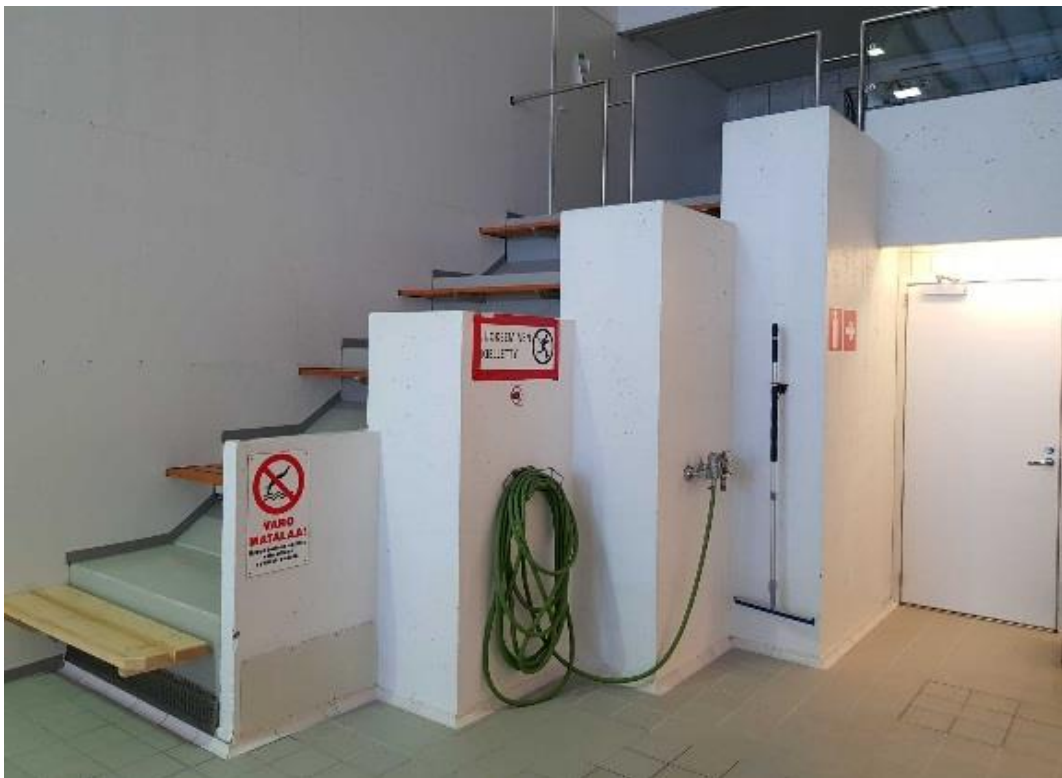
Alkuperäisiä katsomorakenteita. Katsomon halki kulkeva väliseinä on väliaikainen ratkaisu, joka erottaa käytöstä poistetun ison altaan uimahallin käytössä olevista tiloista.
