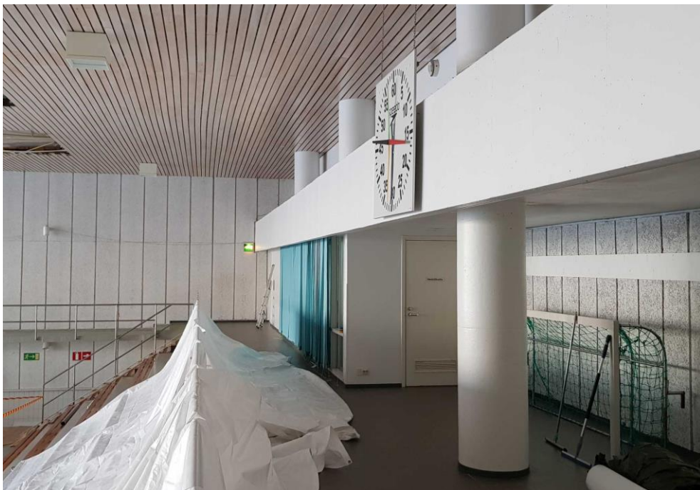
Allassalissa katsomon taustaseinän alkuperäiset sementtilastuvillalevyverhoukset ovat säilyneet. Seinäpinnat on peruskorjauksen yhteydessä maalattu. Allassalin päätyseinällä sisäpuoliset verhoukset on Kemin kaupungilta saatujen tietojen mukaan uusittu vuonna 2004.
