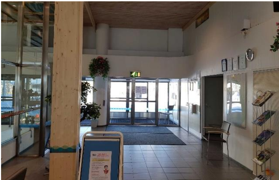
Näkymä aulasta kohti pääsisäänkäyntiä. Myös aulatiloiissa kattorakenteita on jouduttu tukemaan väliaikaisilla puupilareilla.
