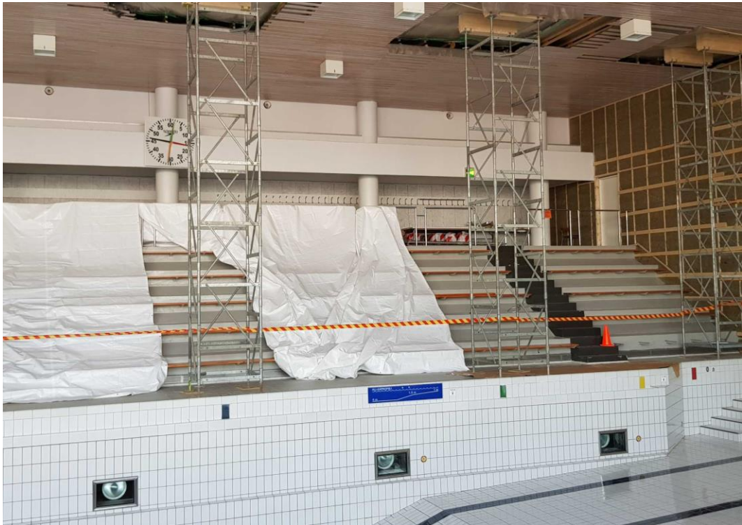
Katsomo on säilynyt pitkälti alkuperäisessä asussaan. Kuvassa näkyvät myös väliaikaiset rakenteet, jotka on jouduttu tekemään kattorakenteissa todetun sortumavaaran vuoksi. Allassalin kattoa kannattavat väliaikaiset tuennat. Allassalin suljettu osa on erotettu väliaikaisella seinärakenteella.
