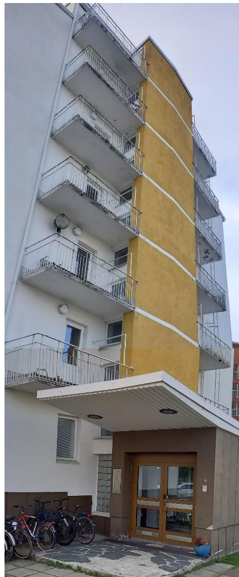
Kuva 9 (yllä). Keltaisen, v.1958 valmistuneen pistetalon pohjoinen julkisivu sisäänkäynti- ja parvekerakenteineen kaipaa kunnostamista (J.Lokio 2022).
