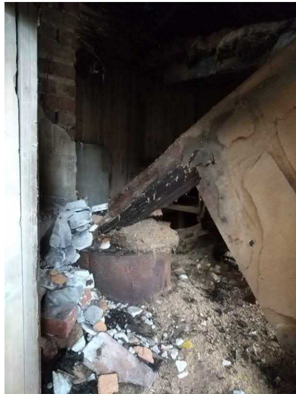
Saunan yläpohja on romahtanut.
