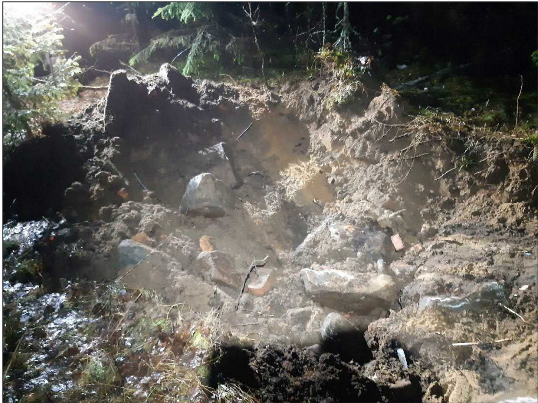
Kuva 4. Koekuopassa KK7 todettiin tiilijätettä maaperän pintakerroksissa (1.11.2021).
