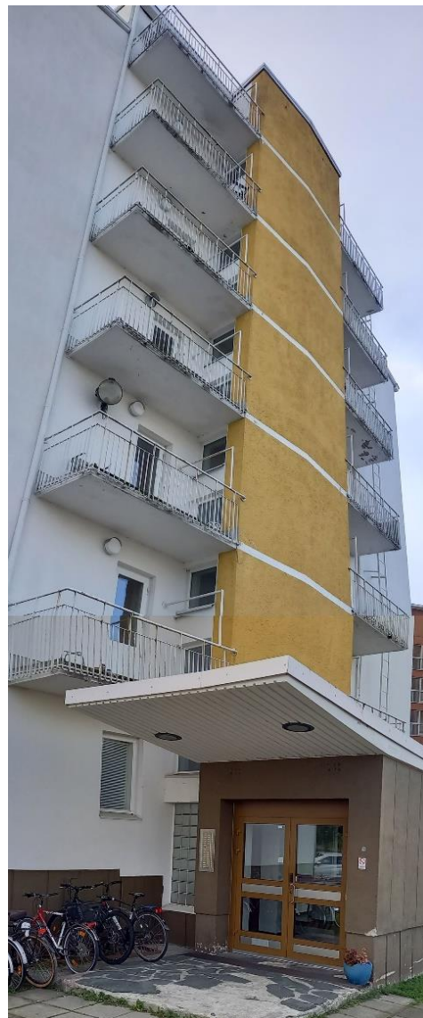
Kuva 9 (yllä). Keltaisen, v.1958 valmistuneen pistetalon pohjoinen julkisivu sisäänkäynti- ja parvekerakenteineen kaipaa kunnostamista (J.Lokio 2022).
