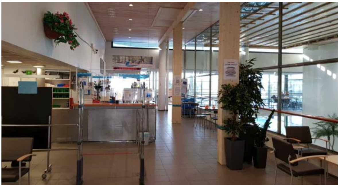
kuva 4. Näkymä sisäänkäynnin luota kohti kassaa ja kahviota. Vanhan osan kattoa on jouduttu tukemaan väliaikaisilla puupilareilla. Ote Kemin uimahallin rakennushistoriaselvityksestä /Sweco Ympäristö Oy 3.5.2019.
