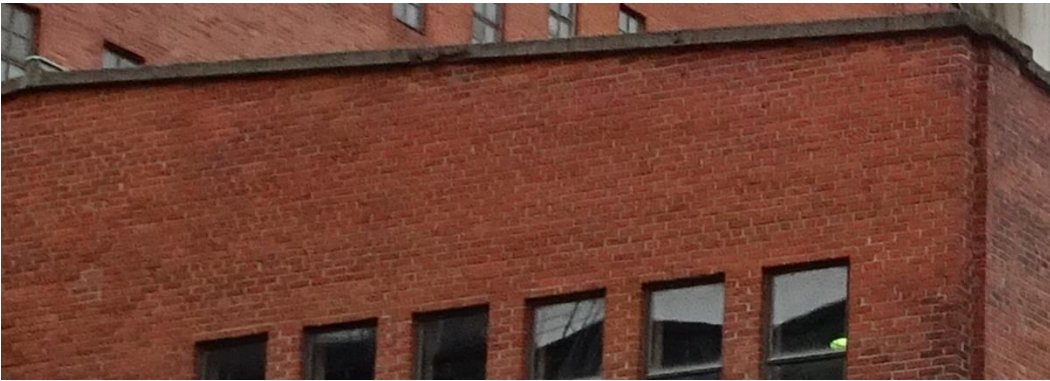
Kuva 58 1959 rakennetun läntisen laajennusosan ikkunoiden yläreunassa ei ole näkyvää palkkia. Kuvälähde: FCG 2022
