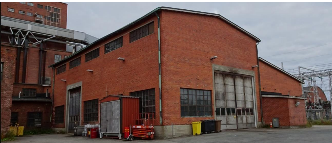
Kuva 106 Kaakosta. Ajoneuvokorjaamo- ja viilaamosiipeen on lisätty betonikehyksiset oviaukot. Kuvälähde: FCG 2022
