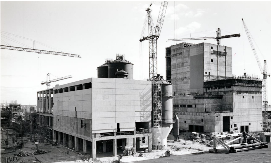
Kuva 304 Sulfaattiselluloosatehtaan rakennustyömaa pohjoisesta vuonna 1976. Kuvan vasemmassa reunassa sellutehtaan kuitulinjan rakennus ja oikeassa reunassa lipeälinjan rakennus. Kuvälähde: Kemin historiallinen museo /676
