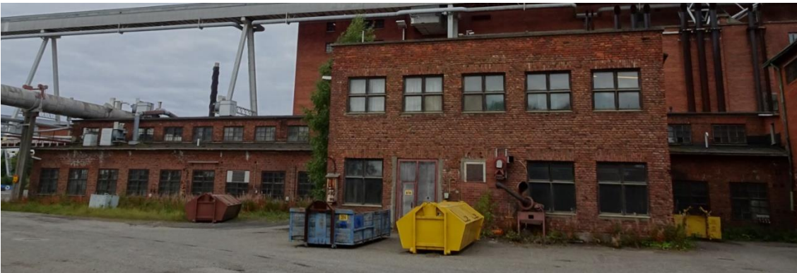
Kuva 105 Idästä. Pajasiiven ikkunat on uusittu ja niissä suuremmat ruudut kuin muualla rakennuksessa. Kuvälähde: FCG 2022
