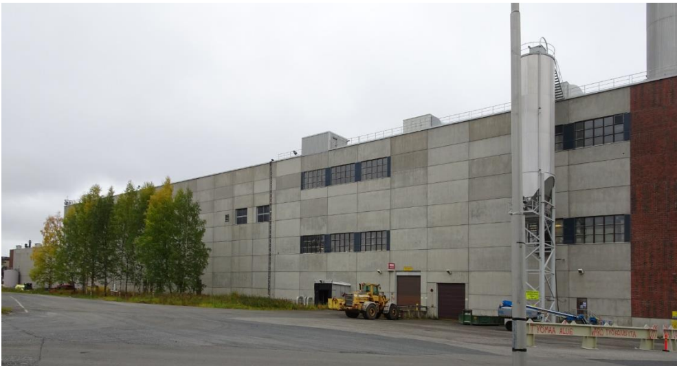
Kuva 301 Koillisjulkisivun länsipää on verhoiltu betonielementeillä. Julkisivu on osa päällystyskonetta ja jälkikäsitteilytiloja varten tehtyä laajennusta. Kuvälähde: FCG 2022
