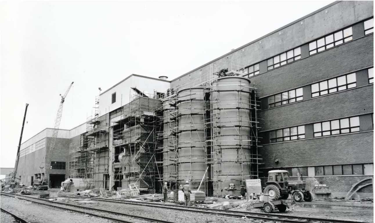
Kuva 194 Kaakkoisjulkisivulla PK1:n konesalin yhteyteen rakennettiin 1980-luvun lopulla laajennusosia. Ne näkyvät valmiina vuoden 1989 ilmakuvassa. Kuvassa vasemmalla näkyvä uusi ulkoneva rakennusosa peittää alkuperäisestä julkisivusta näkyneen jälkikäsitellyn osaston lounaisjulkisivun taakse. Myös kuvan keskivaiheilla näkyvä ulkoneva rakennusosa on uusi ja sen ympärillä on vielä rakennustelineet. Kuvan oikeassa laidassa näkyvän 1960-luvun lopulta olevan rakennusosan alkujaan pieniruutuiset ikkunat on uusittu. Kuvälähde: Kemin historiallinen museo / 883 (4282, 357/82) Paperikone yhden (PK1) rakennustyömaa 26.9.1982. Kuvaaja Mannelin, Helsinki.
