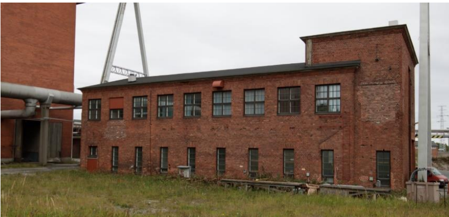
Kuva 119 Lännestä. Kuvassa oikeassa reunassa näkyy umpeutettu kuljettimen aukko. Kuvälähde: FCG 2022
